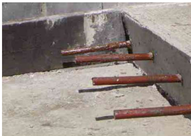
FOTO N° 2, Desalineamiento en Colocado de Barras Pasajuntas con Canastillos Deficientes.
