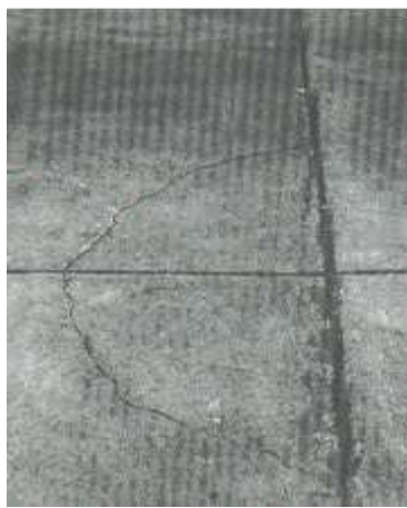
Figura II- 13: Grieta de esquina de severidad media.
