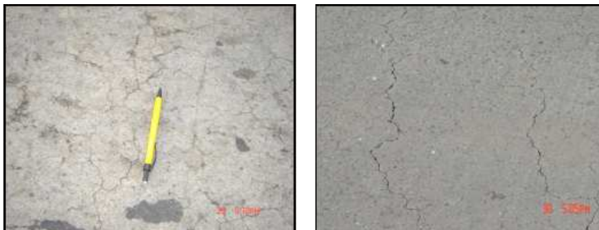
Figura II- 53: Fisuración por retracción típica con nivel de severidad bajo.
