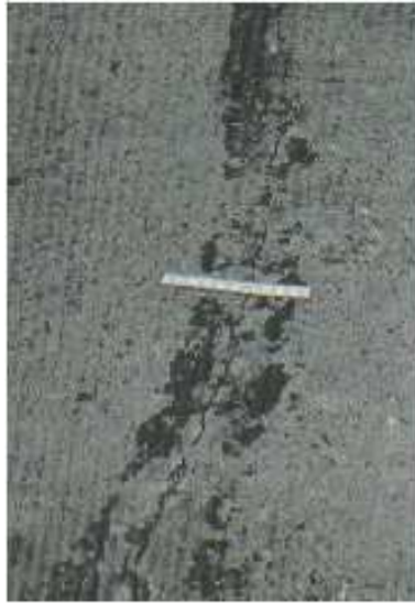
Figura II-17: Grietas lineales de severidad media en losa de concreto reforzado.
