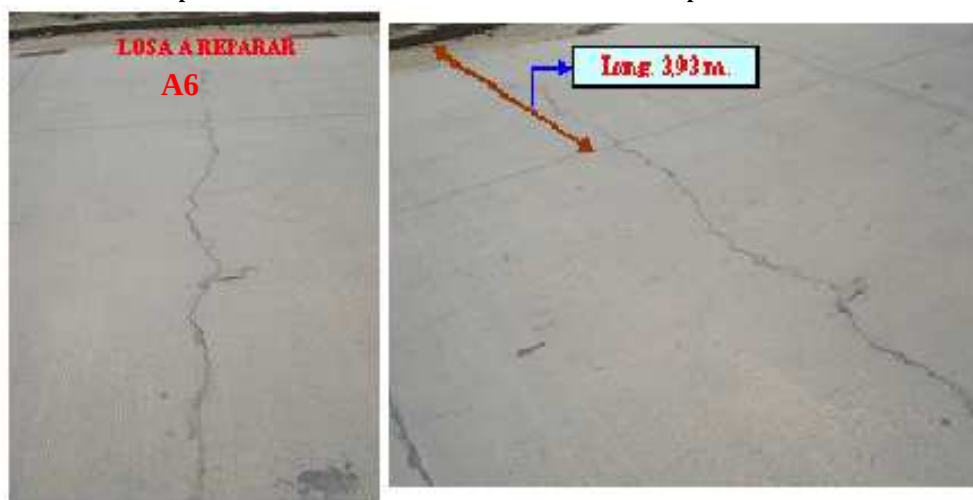
Figura IV- 41: Losa a Reparar de la Muestra 6 en la Zona de Evaluación Superficial.
