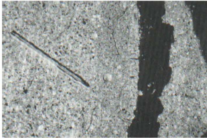
Figura II- 55: Grieta de durabilidad de severidad media.
