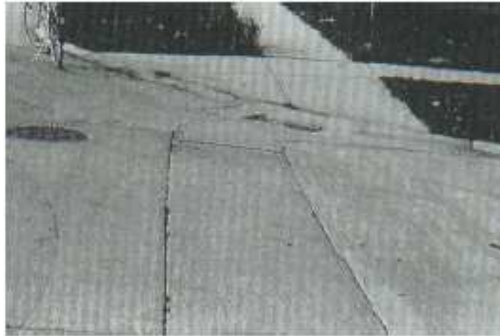
Figura II- 48: Parche grande y acometida de servicios públicos de severidad media.
