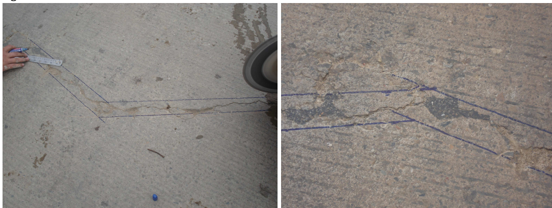
Figura IV- 43: Delimitación de la sección de la Grieta
