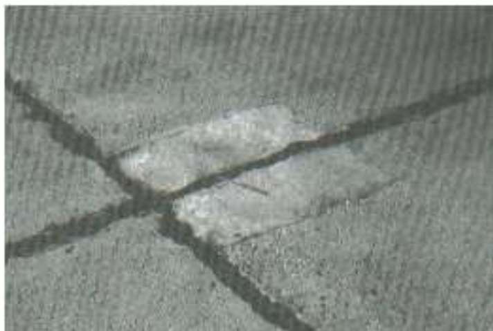
Figura II- 50: Parche pequeño de baja severidad.
