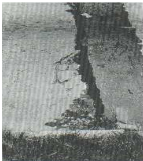
Figura II- 43: Blowup / Buckling de baja severidad.
