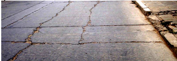
Figura II- 20: Vista típica de una Grieta Transversal.
