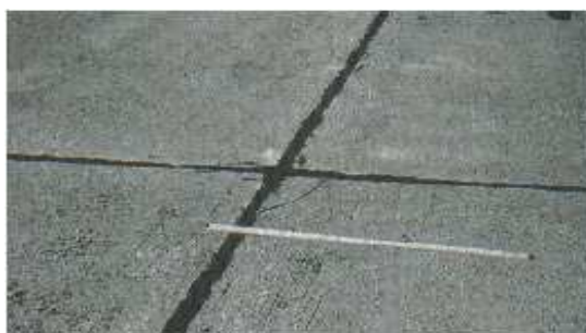
Figura II- 34: Descascaramiento de esquina de baja severidad.
