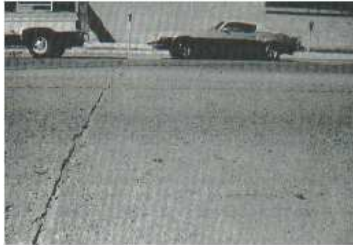
Figura II- 29: Descascaramiento de junta de severidad media.
