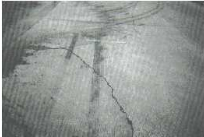
Figura II- 23: Losa dividida de severidad media.
