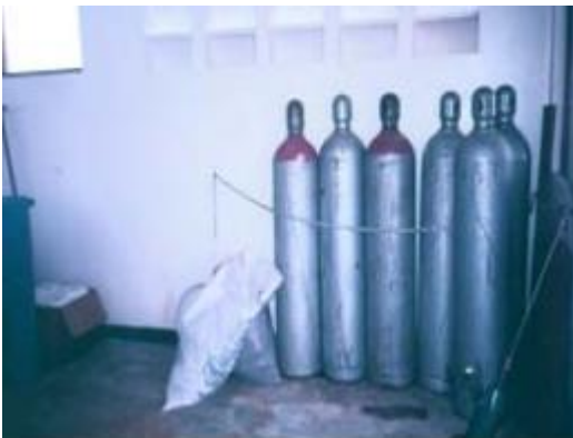
Figura 3.70. Almacén de cilindros pequeños
