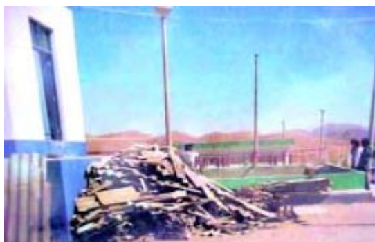
Figura 3.24. Pantallas de asbesto-cemento rotas
