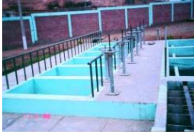
Figura 3.49. Batería de filtros de tasa declinante y lavado mutuo
