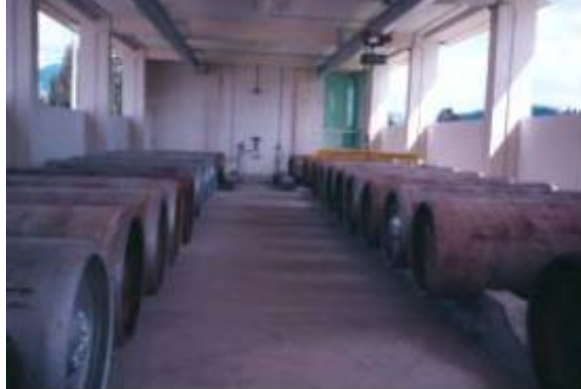
Figura 3.67. Almacén de cloro abierto para cilindros de una tonelada
