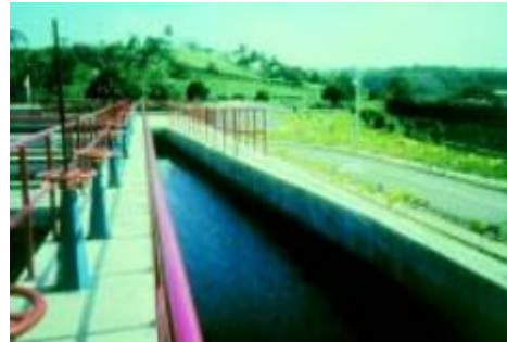
Figura 3.32 Canal de distribución a varios decantadores
