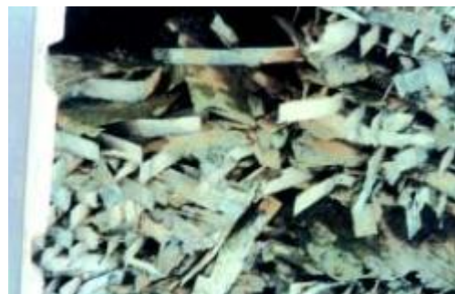
Figura 3.30. Módulos de decantación de plástico deteriorados
