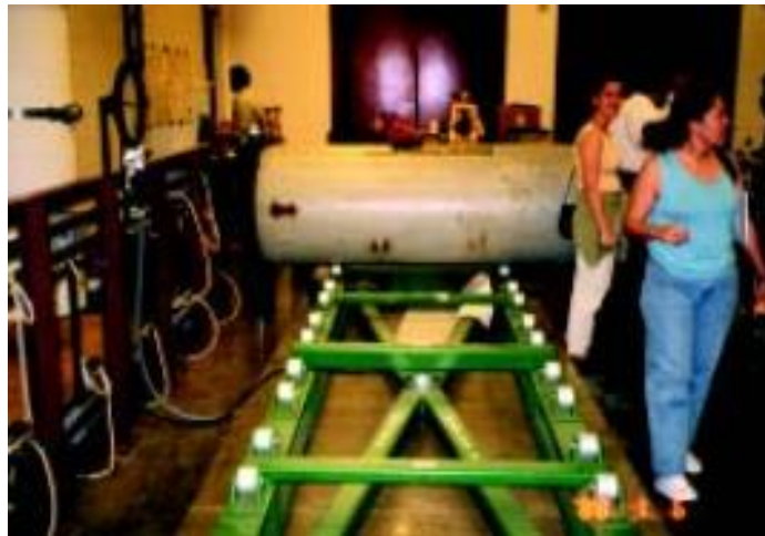
Figura 3.68. Almacén de cloro cerrado con ventilación artificial
