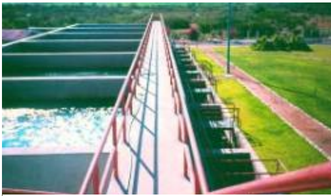
Figura 3.50 Baterías de filtros de tasa declinante con galería de tubos
