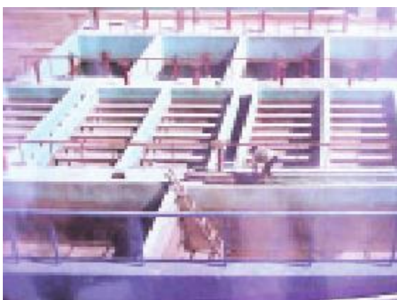
Figura 3.23. Floculador de pantallas después del sismo
