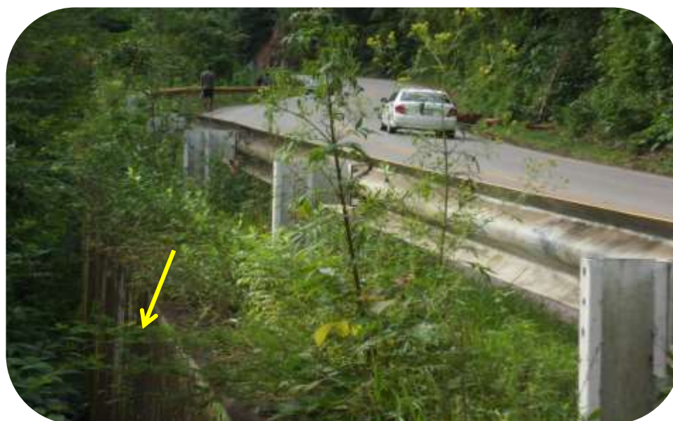
Dispositivo ubicado a lo largo de toda la curva, protegiendo de un desnivel con el río
