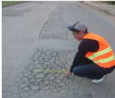
Identificación y Medición de Falla.
