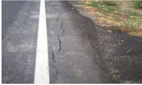
FIGURA 2.13: FISURA DE BORDE
