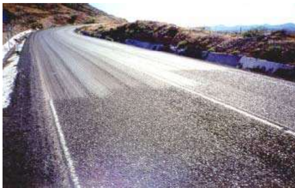
FIGURA 2.24: DISGREGACIÓN Y DESINTEGRACIÓN (DESPRENDIMIENTO)
