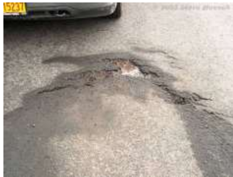
FIGURA 2.22: FISURAS DE DESPLAZAMIENTO
