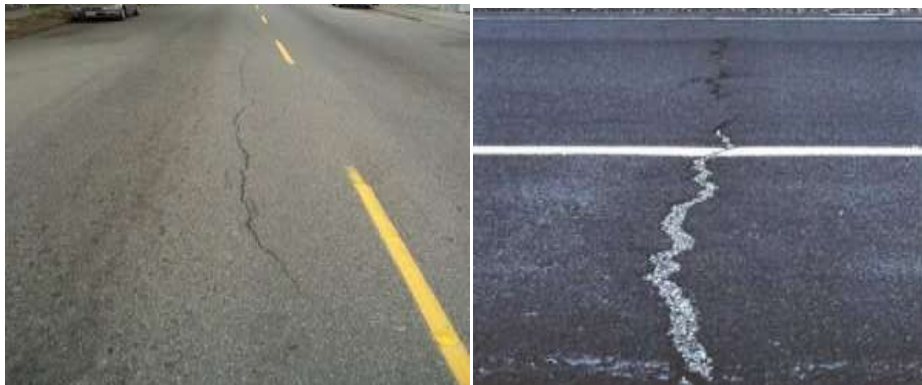
FIGURA 2.16: FISURAS LONGITUDINALES Y TRANSVERSALES
