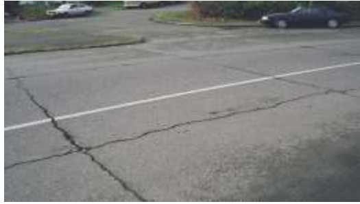
FIGURA 2.14: FISURAS DE REFLEXIÓN DE JUNTAS DE LOSAS
