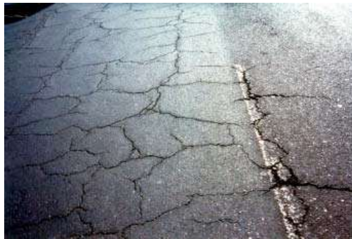
FIGURA 2.9: FISURA DE CONTRACCIÓN (BLOQUE)
