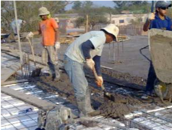
Figura # 51 – (Vaciado de la capa de compresión en un sistema de losas con vigas pretensadas)
