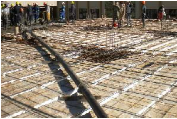
Figura # 43 – (Fotografía de la armadura y complementos colocados en su lugar listo para iniciar el hormigonado)
