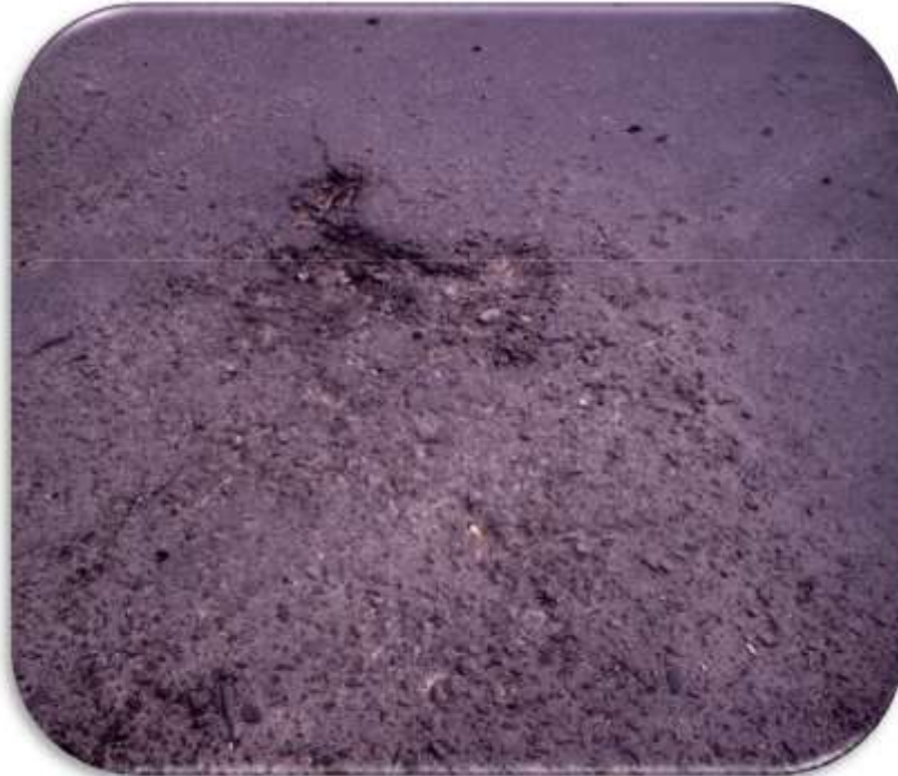
Figura 3.11: Pequeño bache que sobresalta en el pavimento flexible.
