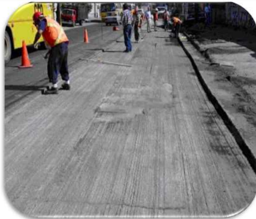
Figura 2.31: Vista de la superficie tras el fresado. Nótese la textura rugosa de la superficie, fundamental para obtener una buena adherencia.
