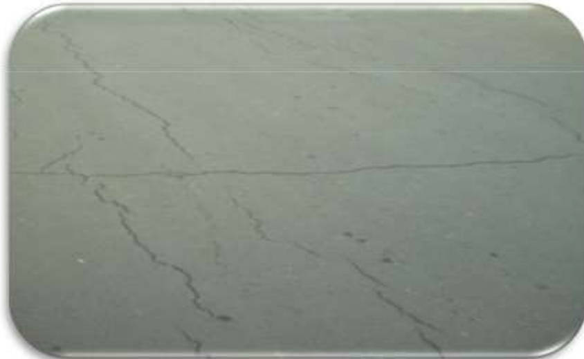
Figura 3.9: Grietas longitudinales y transversales de menor grado.
