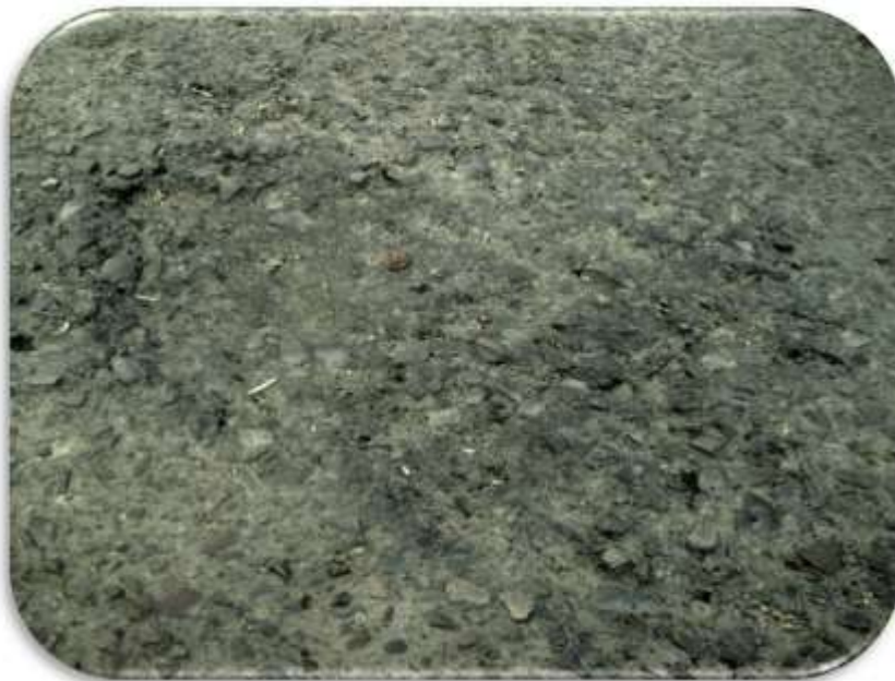
Figura 3.12: Peladuras en pequeñas áreas del pavimento.
