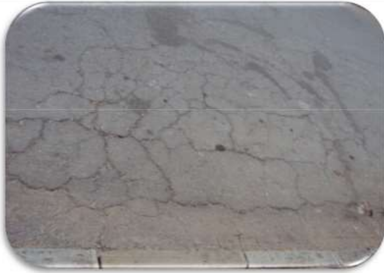
Figura 3.7: Piel de cocodrilo de mayor grado ubicado entre Av. Potosí y Rosendo Estensoro.
