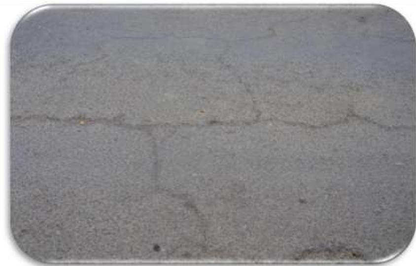
Figura 3.10: Grietas longitudinales de mediano grado ubicados entre Av. Los Membrillos y Rosendo Estensoro.
