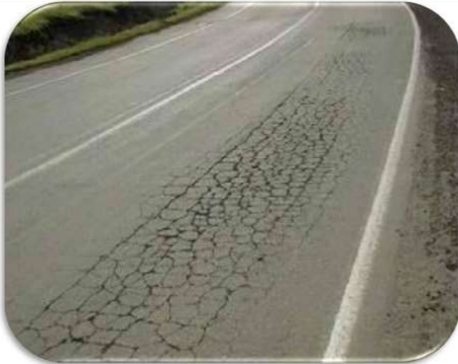
Figura 2.4: Piel de Cocodrilo, falla típica de los pavimentos de asfalto.
