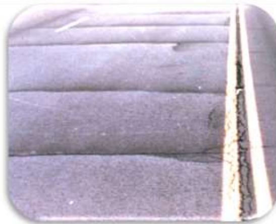
Figura 4.34: Fisuras Reflejadas (sobre carpeta de asfalto sobre pavimento rígido)
