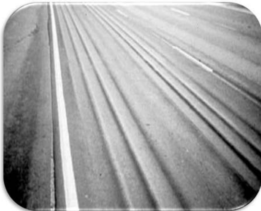
Figura 2.5: Ahuellamiento severo de un pavimento asfáltico.
