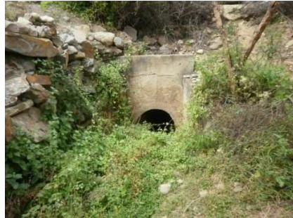
Cabezal aguas arriba aparentemente dejó de funcionar.
