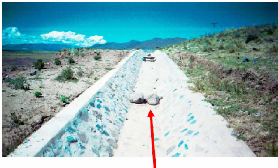
Figura 3.7. Zanja de Coronación con obstrucciones
