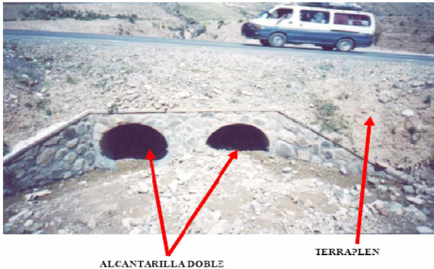
Figura 3.6. Alcantarilla doble semi colmatada
