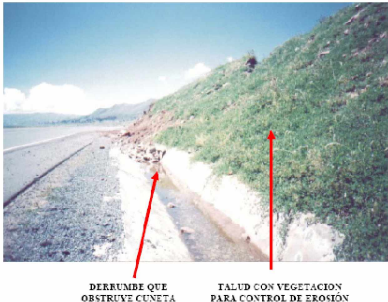
Figura 3.9. Derrumbe que obstruye la cuneta
