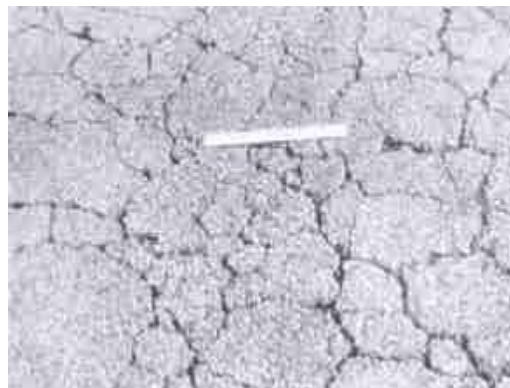
Figura N° 4.7. Fisura de Alto Nivel
