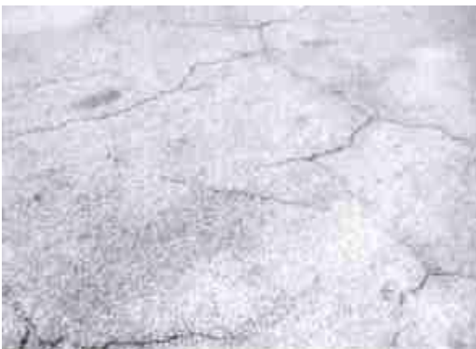
Figura N° 4.6. Fisura de Bajo Nivel
