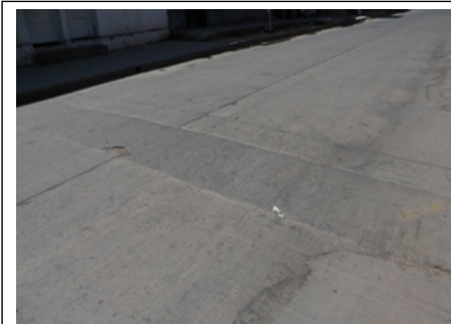
4.24. ROMPEMUELLE SIN SEÑALIZACION
