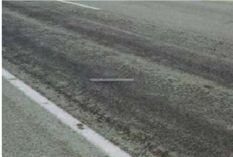
FIGURA 3.11. EXUDACION DEL ASFALTO
