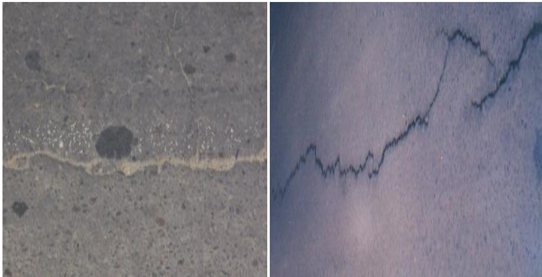
FIGURA 3.19. GRIETAS LONGITUDINALES Y TRANSVERSALES
