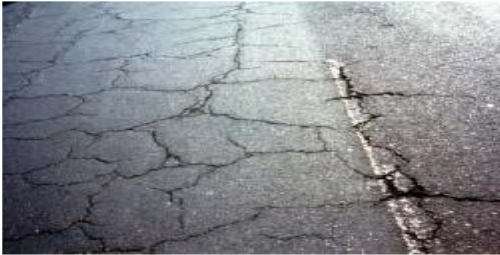
FIGURA 3.12. GRIETAS DE CONTRACCION
