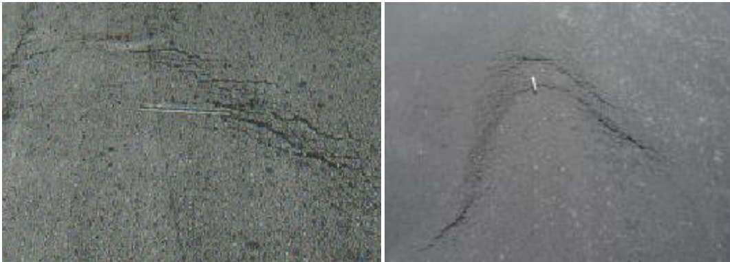
FIGURA 3.26. GRIETAS DE DESLIZAMIENTO
