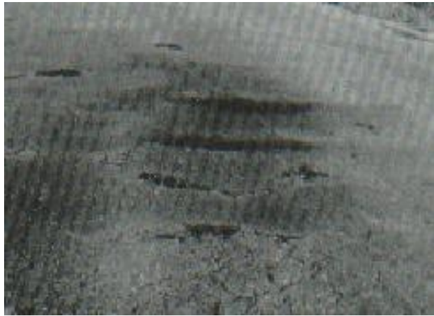
FIGURA 3.25. DEFORMACION POR EMPUJE
