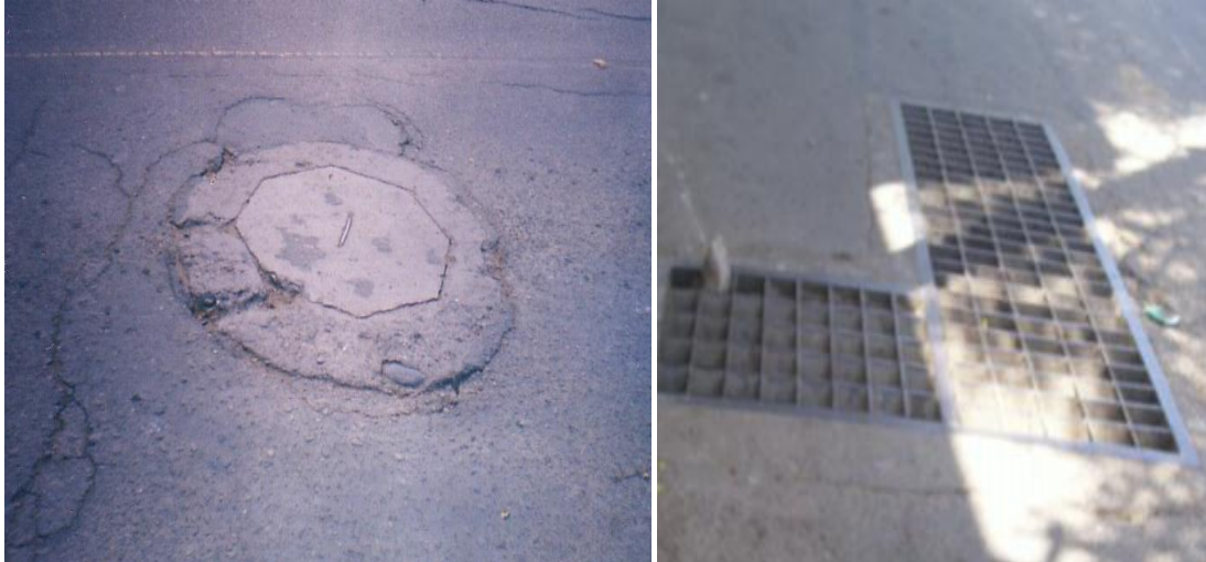
FIGURA 3.23. REJILLAS Y TAPAS DE ALCANTARILLAS
