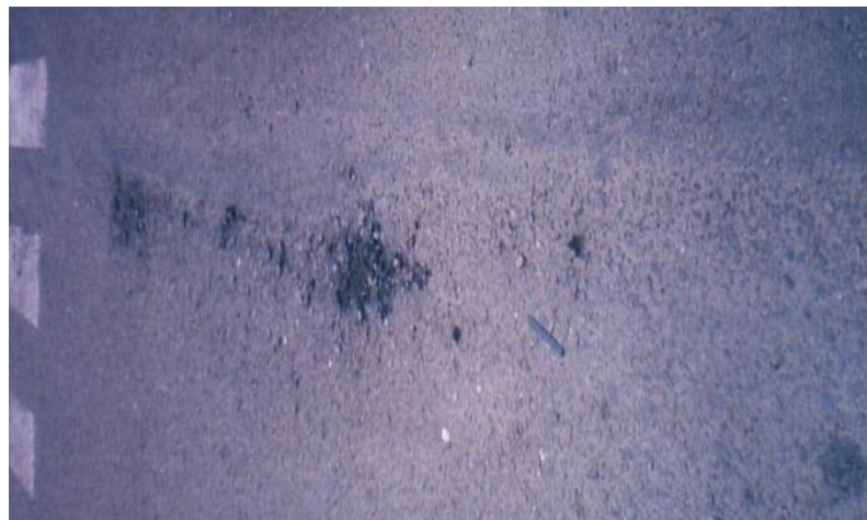
FIGURA 3.28. DISGREGACION DEL PAVIMENTO
