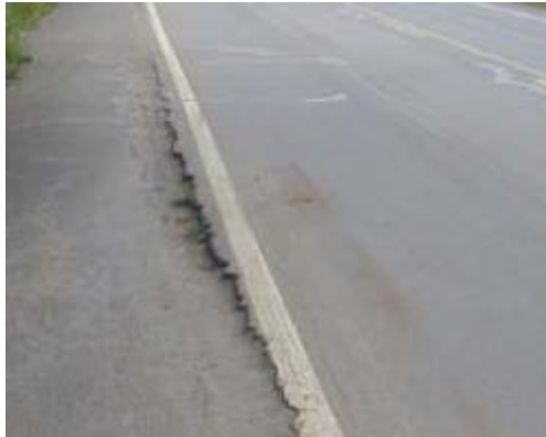
Fotografía 2.22 Desnivel Calzada - Berma Fuente: INVIAS Colombia
