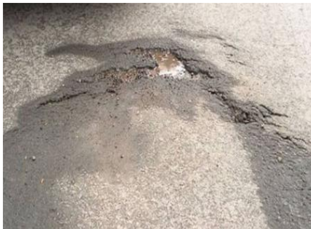
Fotografía 2.30 Grietas de Deslizamiento Fuente: INVIAS Colombia
