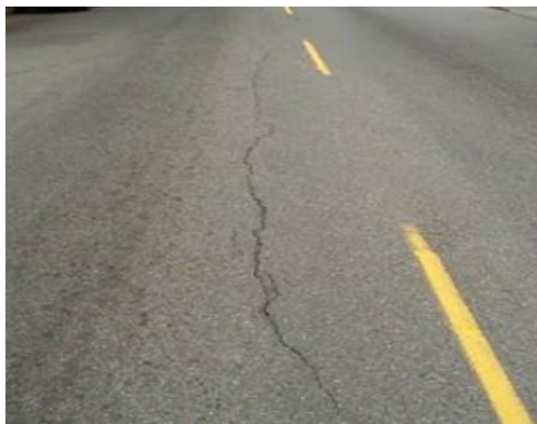
Fotografía 2.23 Grietas longitudinales y transversales Fuente: INVIAS Colombia
