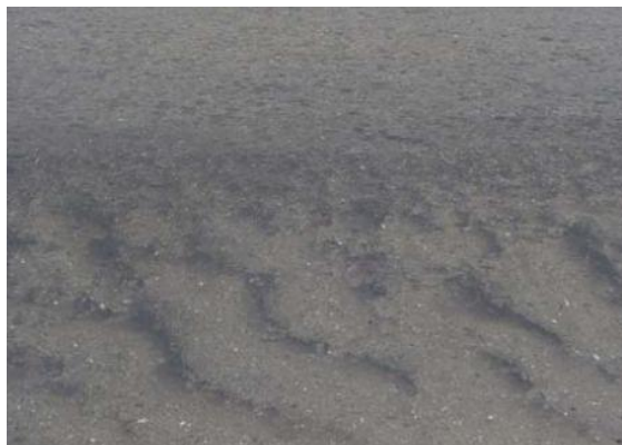
Fotografía 2.15 Exudación del asfalto Fuente: INVIAS Colombia
