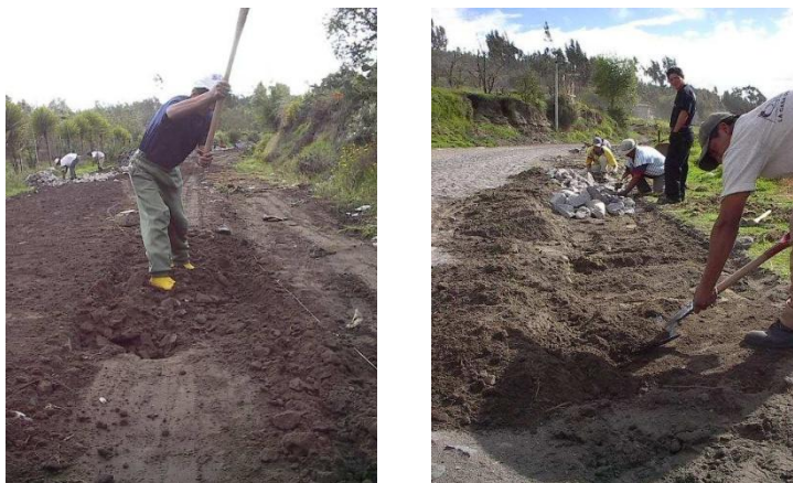
Fotografía 2.7 Disgregación de Subrasante Fuente: OIT
