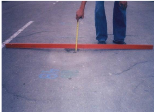
Fotografía 2.19 Depresiones Fuente: INVIAS Colombia
