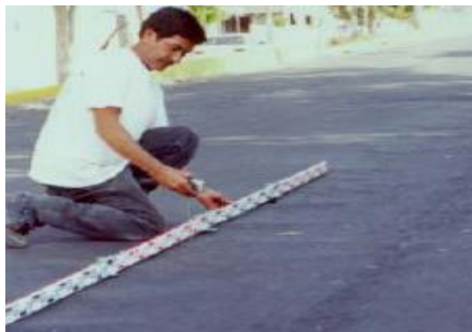
Fotografía 2.18 Corrugaciones Fuente: INVIAS Colombia
