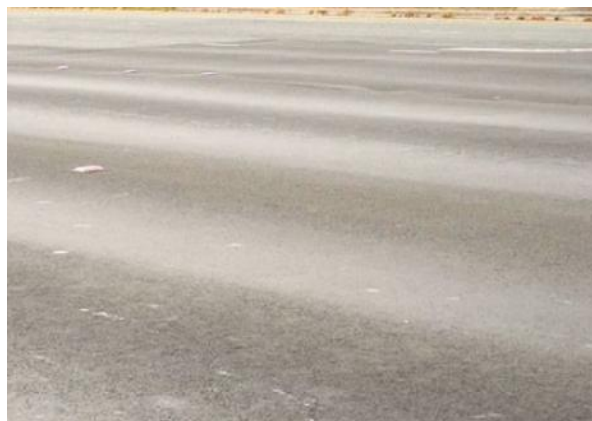
Fotografía 2.28 Ahuellamiento Fuente: INVIAS Colombia
