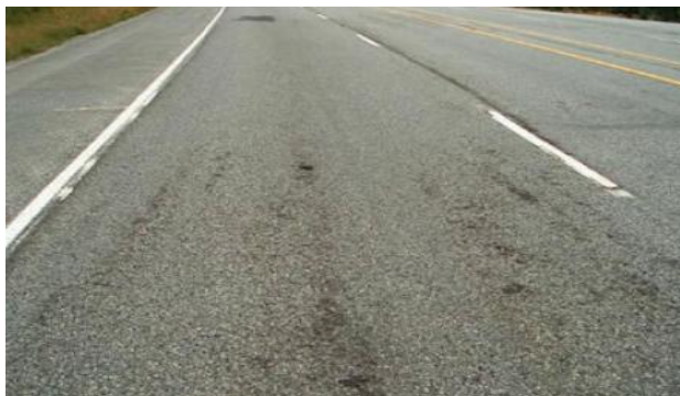
Fotografía 2.32 Disgregación y Desintegración Fuente: INVIAS Colombia
