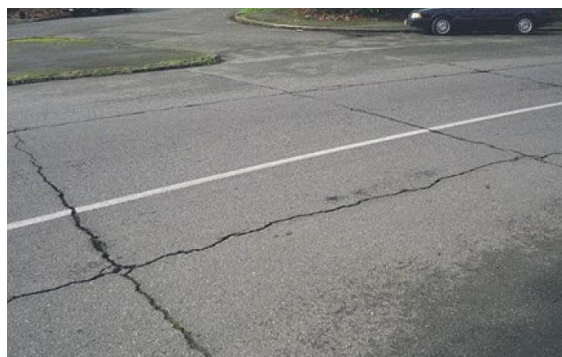
Fotografía 2.21 Grietas de reflexión de juntas Fuente: INVIAS Colombia
