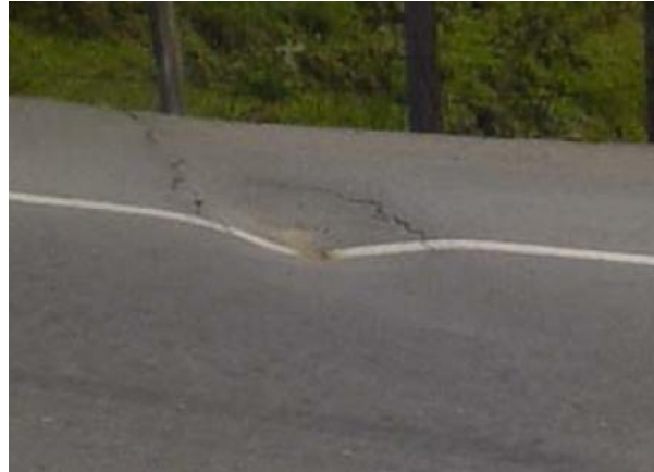
Fotografía 2.17 Elevaciones y Hundimientos Fuente: INVIAS Colombia
