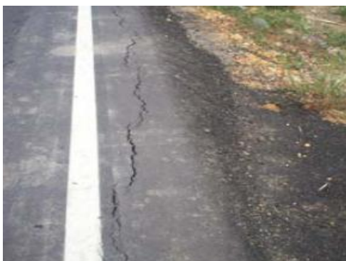
Fotografía 2.20 Grietas de Borde Fuente: INVIAS Colombia
