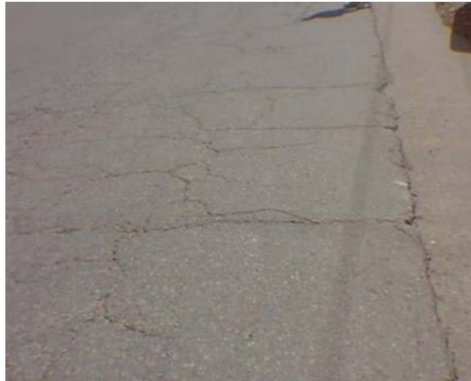
Fotografía 2.16 Grietas contracción ó Bloques Fuente: INVIAS Colombia
