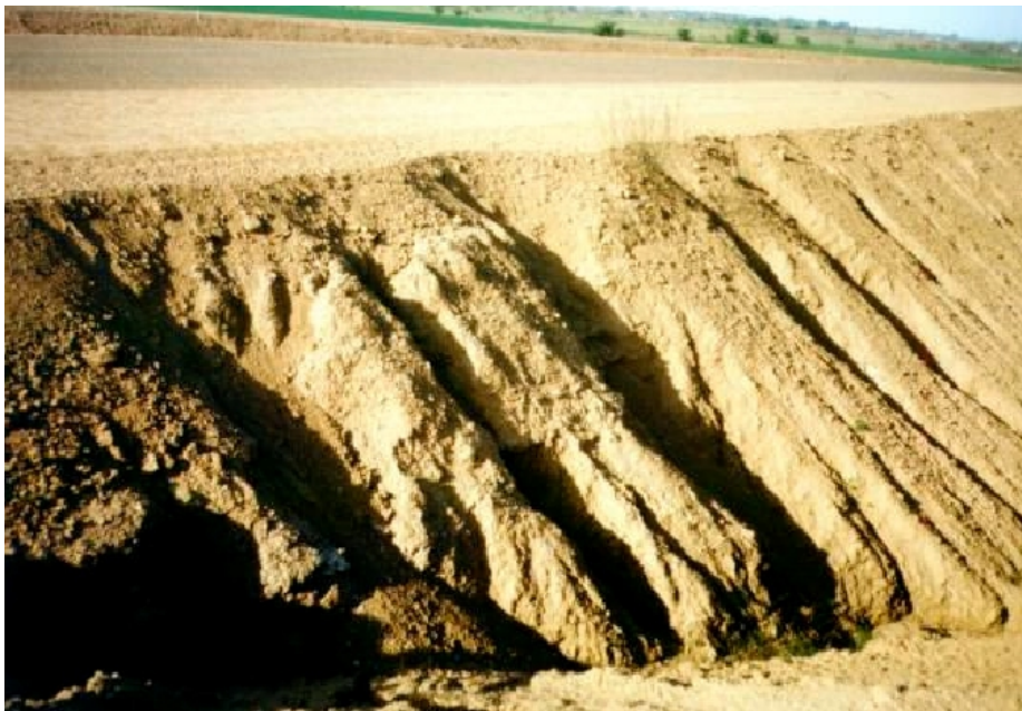
Foto 1: Vista del talud que forma parte de un terraplén
