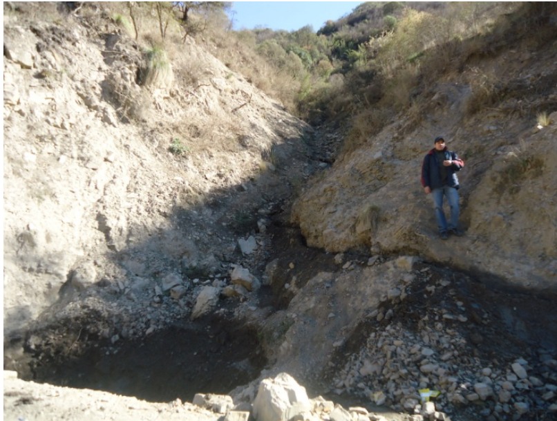
Fotografía 4.39. Presencia de agua Talud “C”
