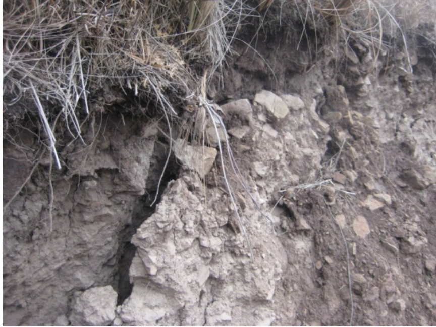
Fotografía 4.45. Erosión Talud “D”
