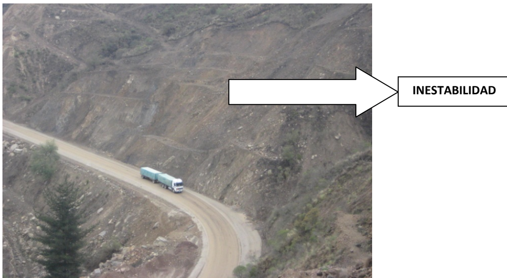
Fotografía 4.30. Inestabilidad Talud “D”
