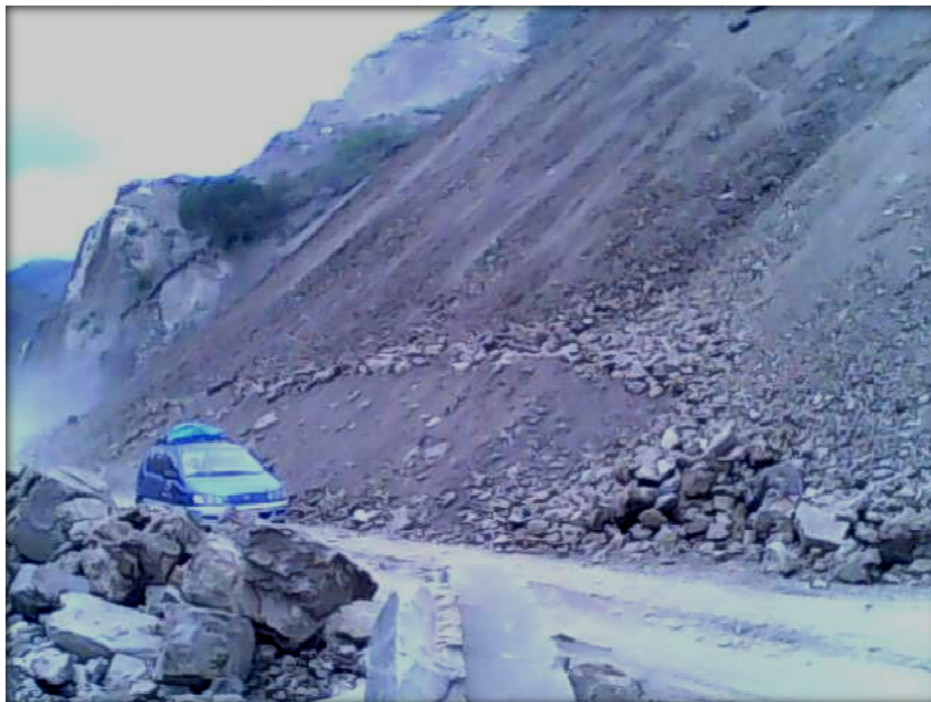
Fotografía 4.44. Deslizamiento Talud “D”
