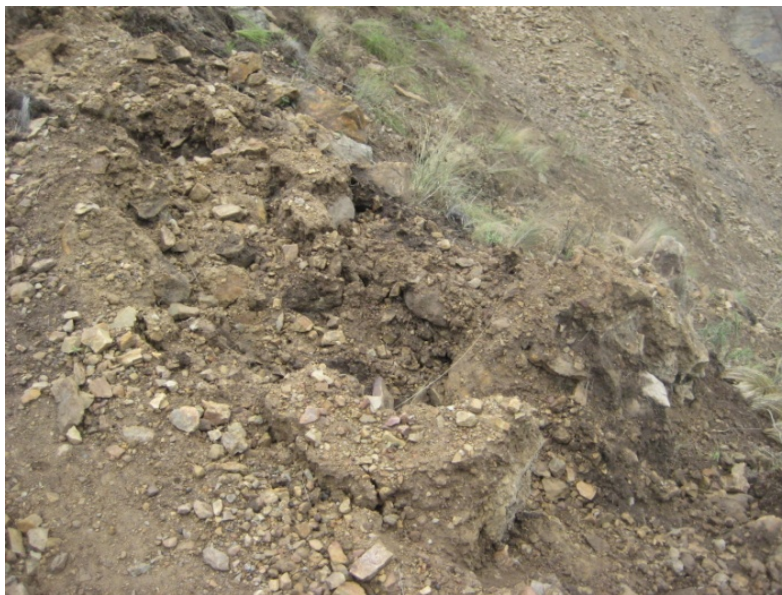
Fotografía 4.42. Cárcavas de Erosión Talud “C”
