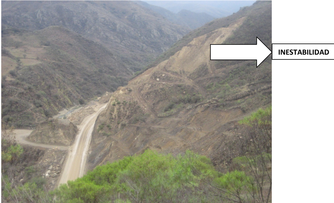
Fotografía 4.29. Inestabilidad Talud “C”
