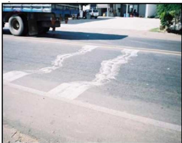
Figura 2.15. Ahuellamiento (AHU, Unidad de medida: m2)
