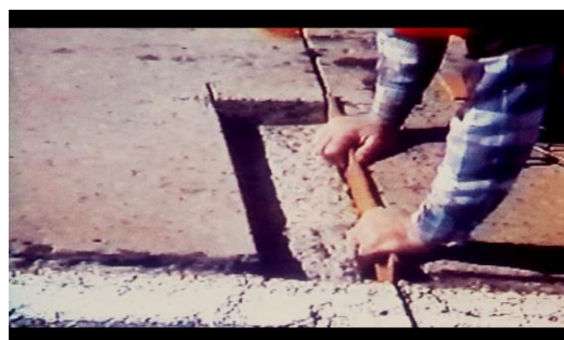
Foto 4.20 Inserto compresible en la junta debido a un apoyo puntual
