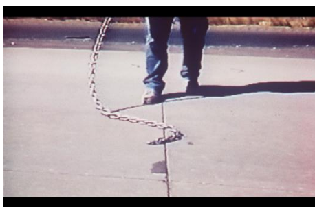
Foto 4.13 Identificación de áreas deterioradas
