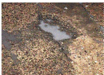
a) El agregado silíceo, quedo expuesto en la superficie y fue atacado químicamente.
