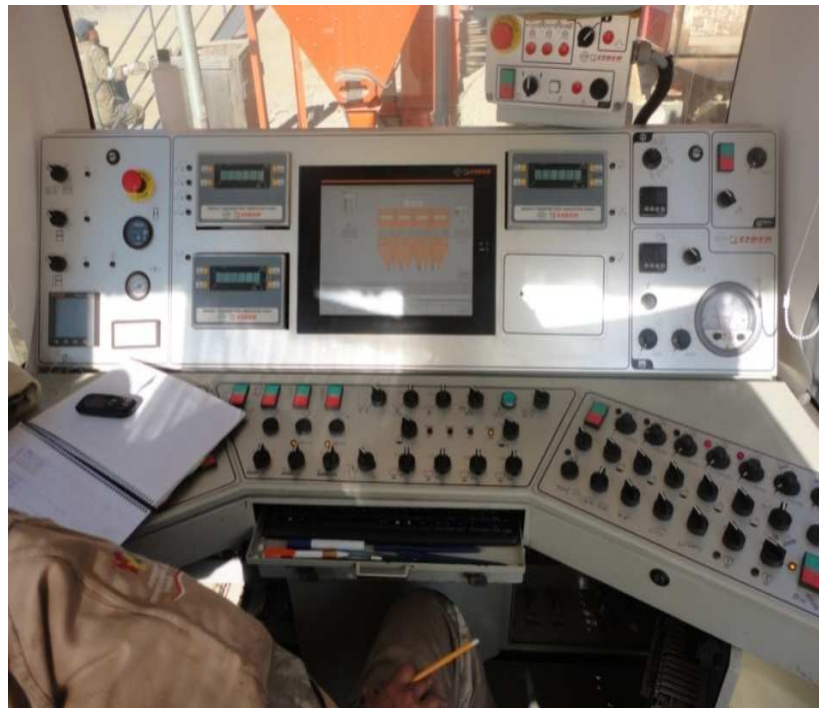
Fig. 4.32. Panel de control General.
