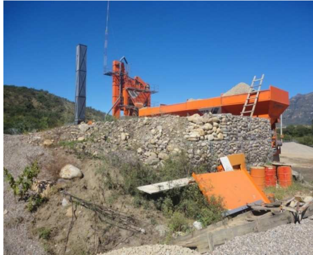
Figura. 3.3. Rampa para carga de agregados a los silos.
