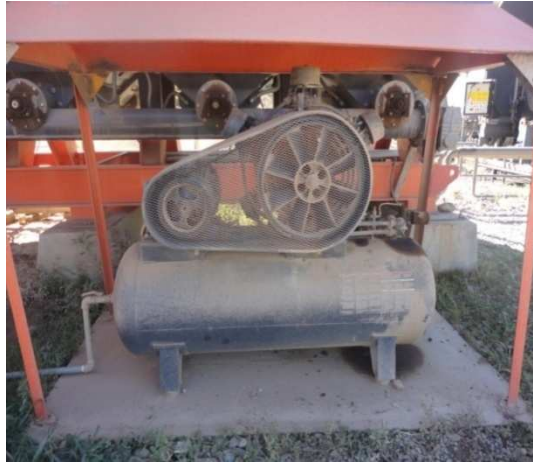
Fig. 3.4. Compresor de aire.
