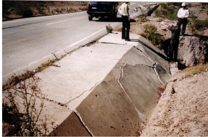
Foto 16. Por las condiciones que se tiene en el cabezal de salida de la alcantarilla, se comienza a percibir fallas laterales que
