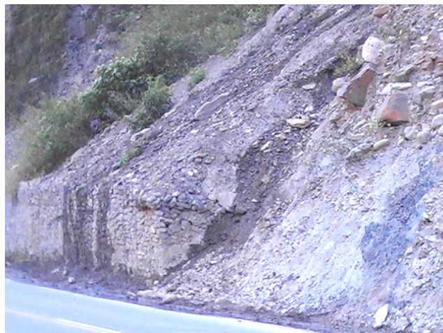
Foto 9. Presencia de agua que se filtra en talud
