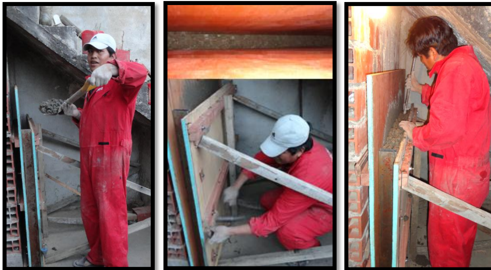
Paso N°5.19. Transporte del hormigón en el encofrado y golpeteo y apisonado Fuente Propia
