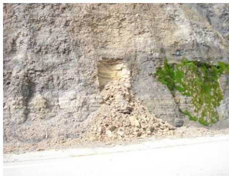
Fotografía 5.5 Deslizamiento y humedad
