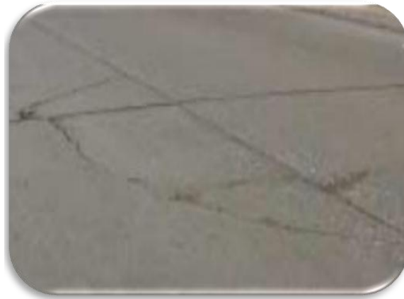
Figura N°5, fisura de esquina.
