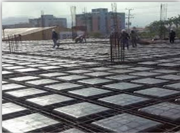
Figura 19. Limitaciones en el Armado de soportes
