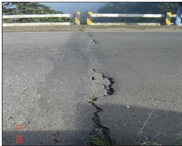
Gráfica N°7. Fisuras por reflexión de juntas en placas de concreto
