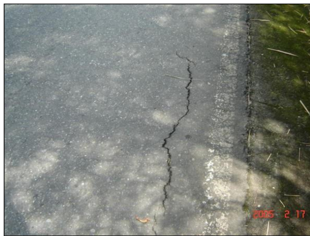
Gráfica N°9. Fisuras de borde
