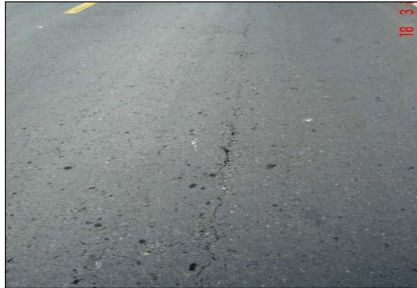
Gráfica N°4. Fotografía de Fisura longitudinal
