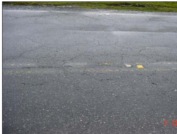
Gráfica N°10. Fisuras en bloque
