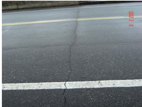
Gráfica N°5. Fotografía de Fisura Transversal
