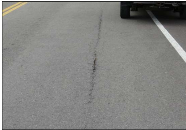
Gráfica N°6. Fotografía Fisura longitudinal en junta de construcción
