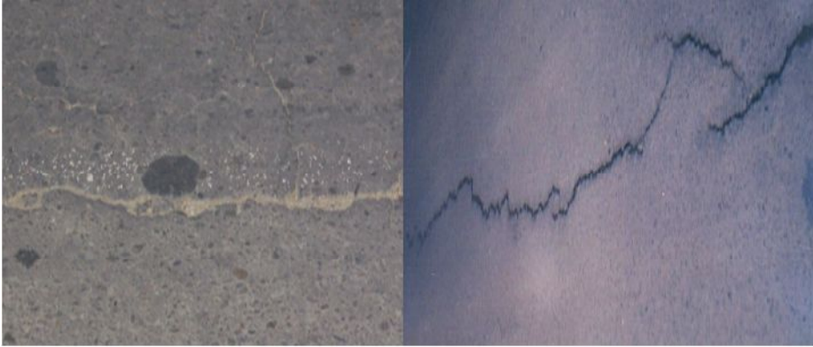
Figura 3.18 Falla por grietas longitudinales de nivel de severidad media
