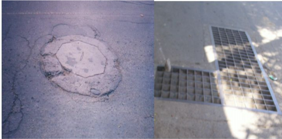
Figura 3.25 Falla por rejillas de drenaje y tapas de alcantarilla
