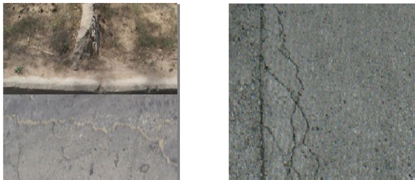
Figura 3.12 Falla por grieta de borde
