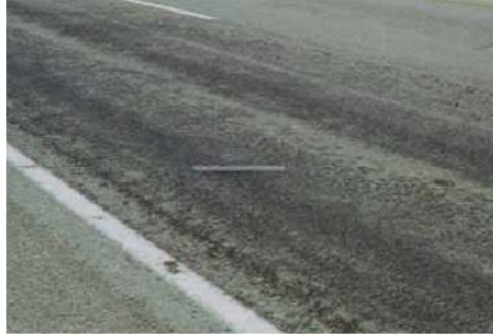
Figura 3.4 Nivel moderado de exudación
