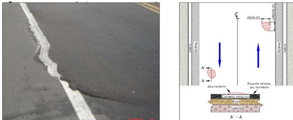
Figura 3.8 Falla por abultamiento
