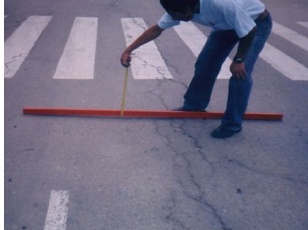
Figura 3.26 Falla por ahuellamiento
