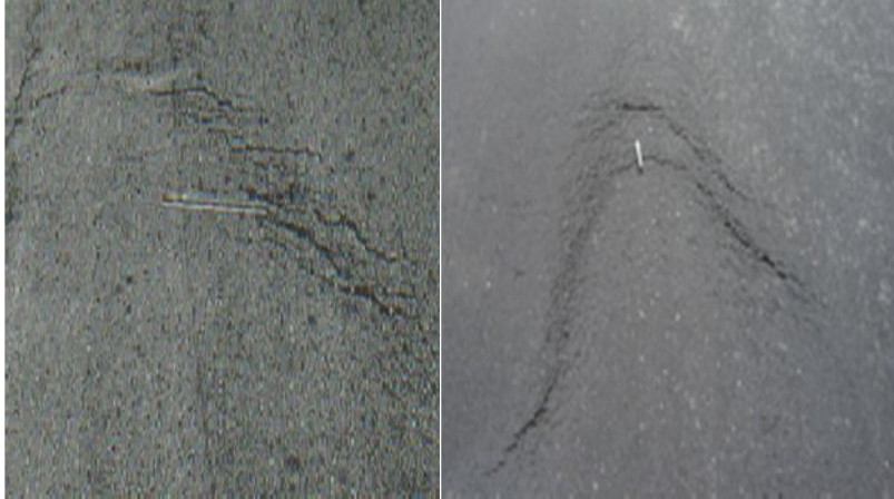
Figura 3.29 Falla por grietas de deslizamiento
