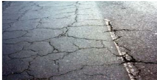
Figura 3.6 Nivel moderado de agrietamiento en bloque
