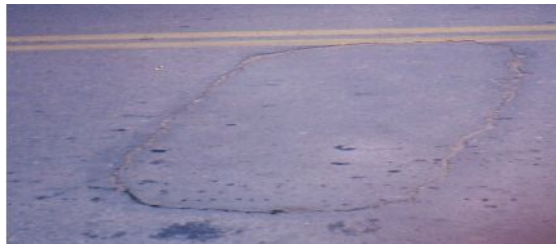
Figura 3.20 Falla por parcheo de nivel de severidad media
