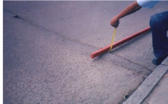
Figura 3.7 Nivel moderado de abultamiento
