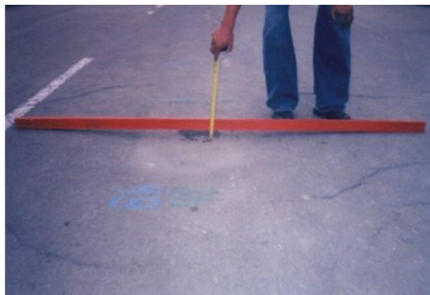
Figura 3.11 Falla por depresión nivel de severidad media
