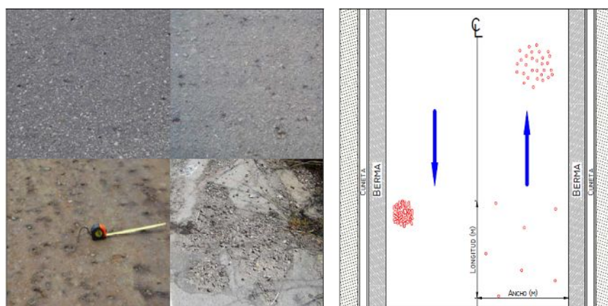
Figura 3.33 Falla por desintegración de distintos niveles de severidad
