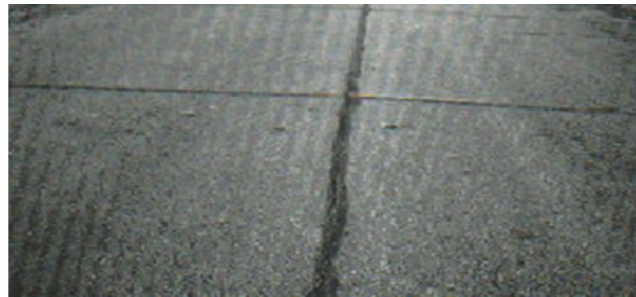
Figura 3.14 Falla por reflexión de juntas
