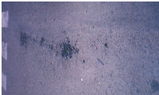
Figura 3.32 Falla por desprendimientos
