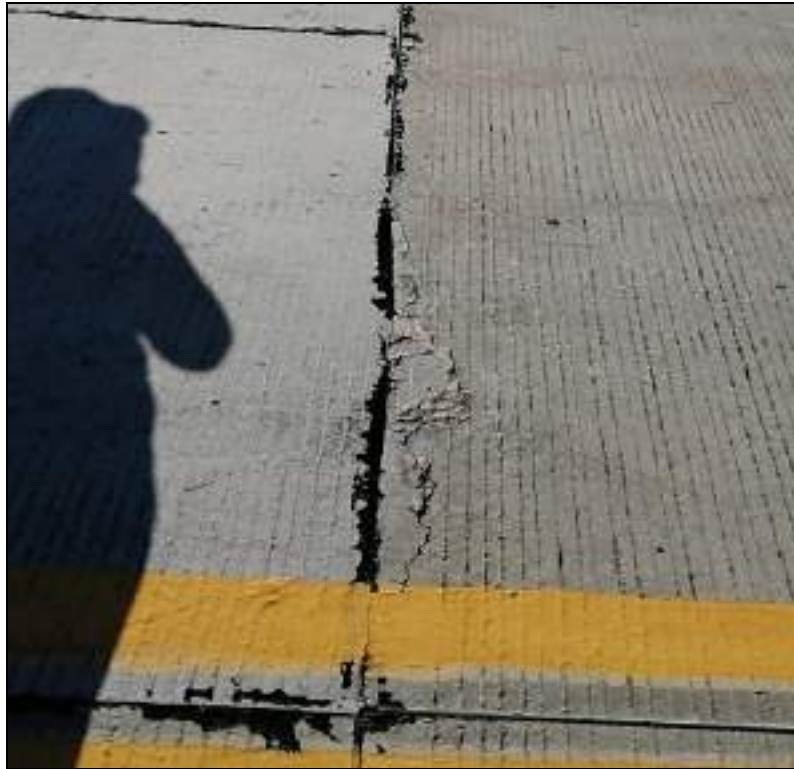
Figura 19: Vista típica de un desportillamiento
