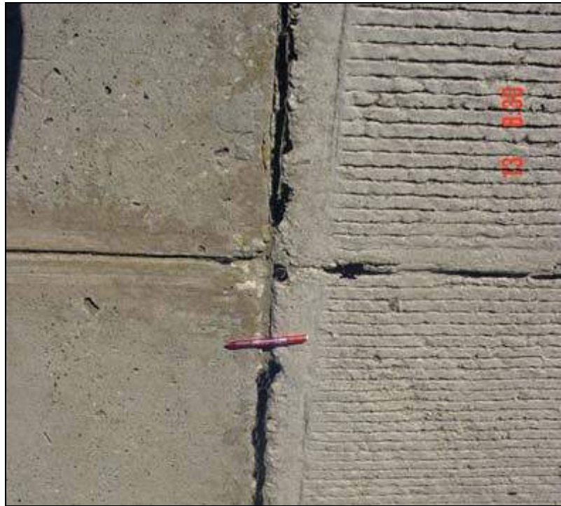
Figura 20: Vista típica de un deterioro de sello
