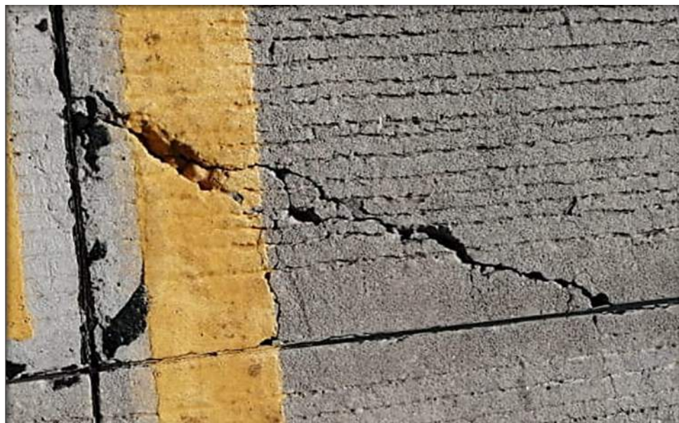
Figura 17: Vista típica de las grietas de esquina
