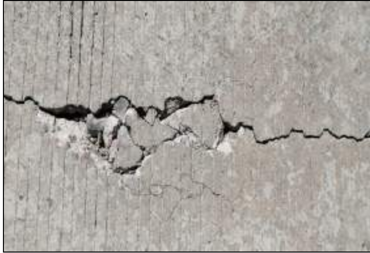
Figura 2: Fisuras presentadas en el tramo en estudio
