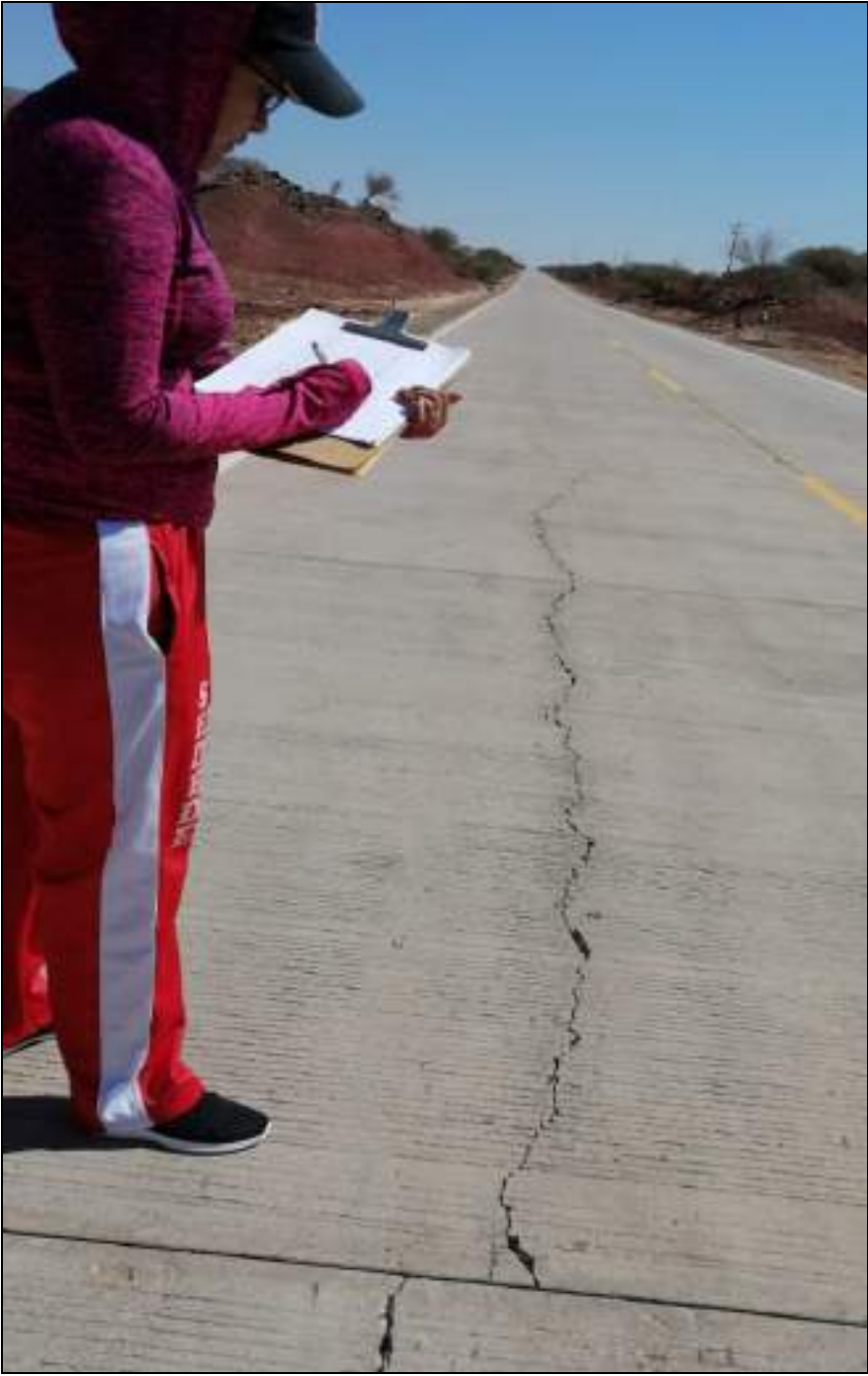
Figura 51: Registro de las fallas encontradas en los tramos
