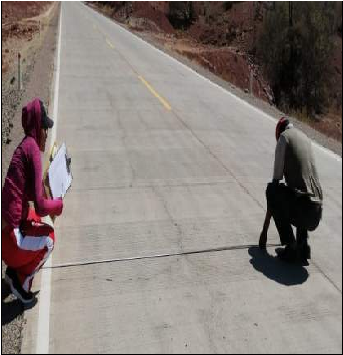
Figura 50: Medición de una falla transversal
