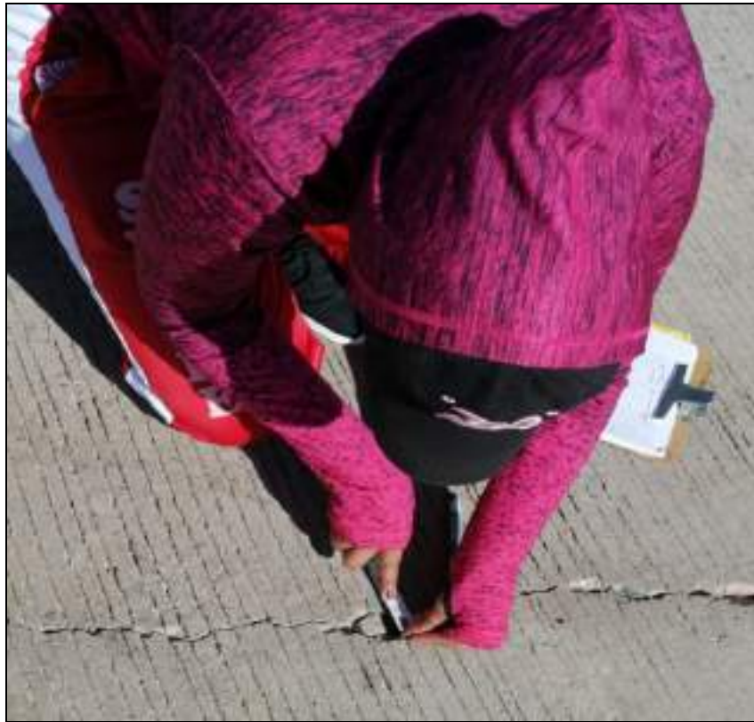
Figura 48: Medición de las aberturas de las fallas encontradas
