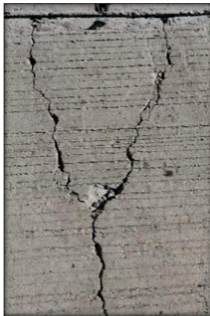
Figura 22: Vista típica de una grieta en bloque
