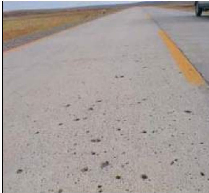
Figura 24: Vista típica de una vía con nivel bajo de desintegración
