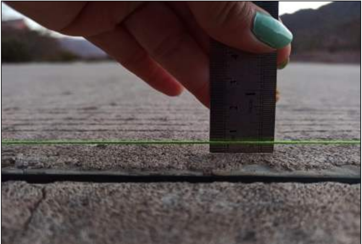
Figura 60: Alabeo presente en una losa de la sección 1
