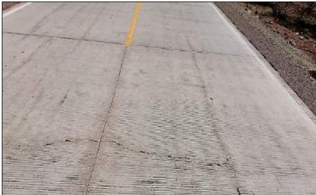
Figura 13: Vista típica de las grietas transversales
