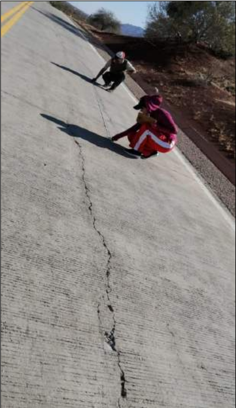
Figura 49: Medición de una falla longitudinal
