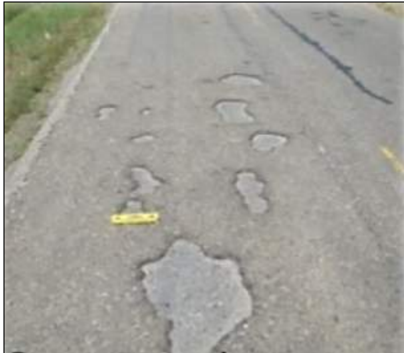
Figura 25: Vista típica de un descascaramiento
