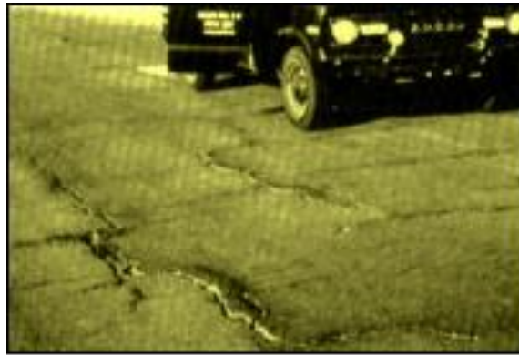
Figura 14. Grietas en bloque de alta severidad
