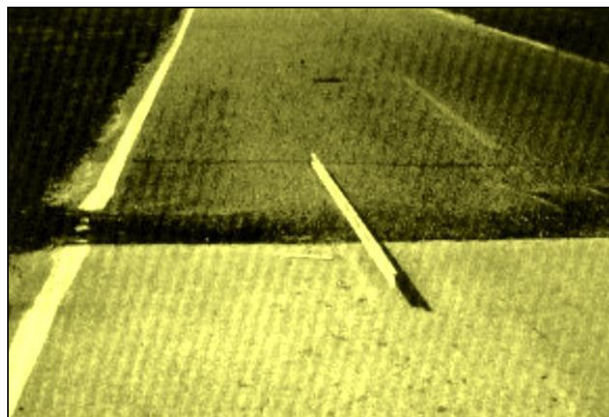
Figura 48. Desplazamiento de severidad alta
