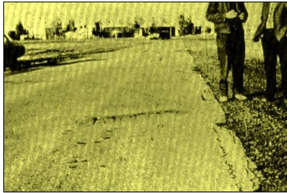
Figura 16. Abultamiento y hundimientos de severidad media
