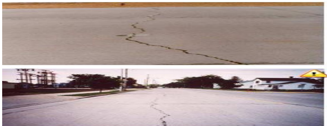
Figura 11. Fisura longitudinal / transversal.
