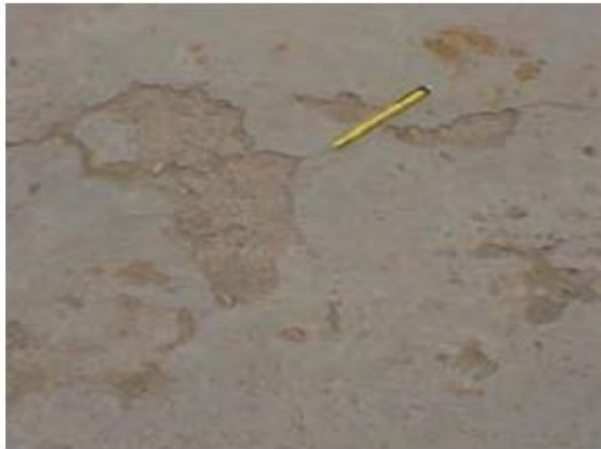
Figura 16.Descascaramiento y fisuras capilares.
