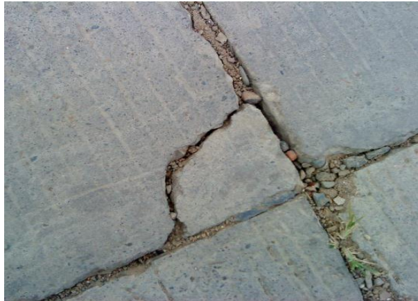
Vista típica de una grieta de esquina
