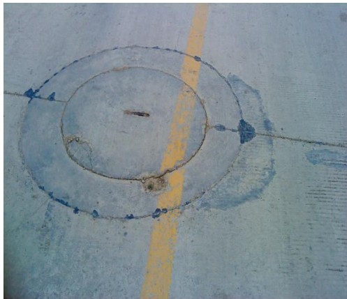
Grietas en pozos de inspección
