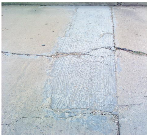
Parches en asfalto y concreto
