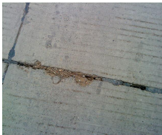
Separación de Juntas longitudinales.
