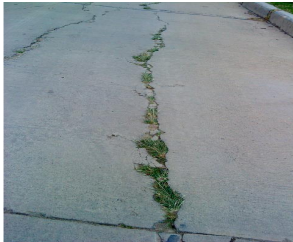
Características de las Grietas Longitudinales
