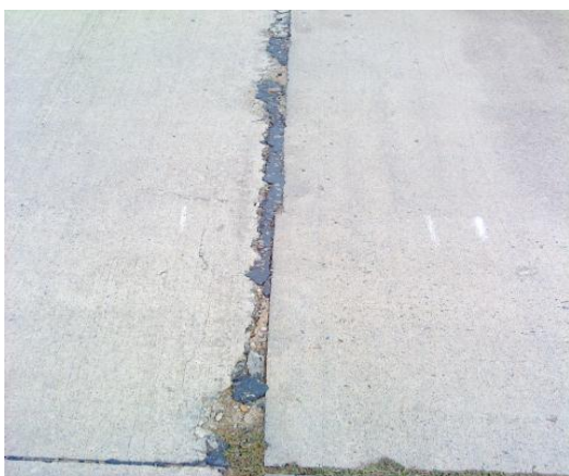
Deterioro de sello.
