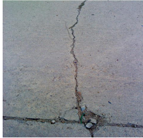
Grietas en los Extremos de los Pasadores
