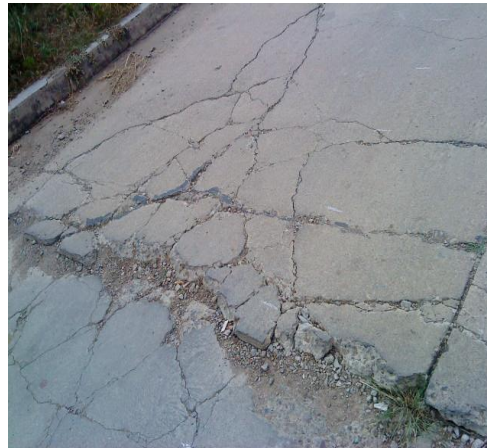
Características de las grietas en bloque
