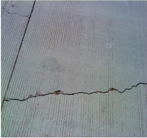
Grietas en los Extremos de los Pasadores
