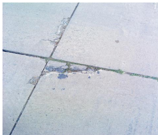
Deterioro de sello.
