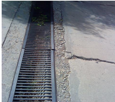
Grietas en pozos de inspección
