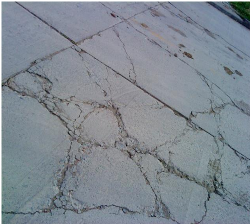
Características de las grietas en bloque
