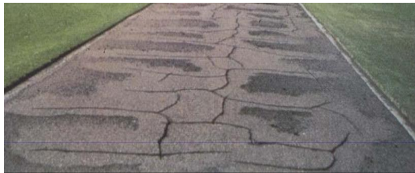
Fig. 2: Grietas de contracción o de bloque
