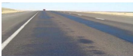
Fig. 4: Manchas de pavimentos
