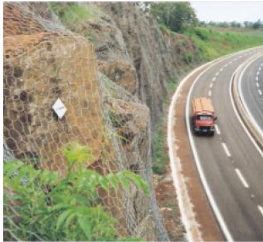
Figura Nro. 15 Protección con malla
