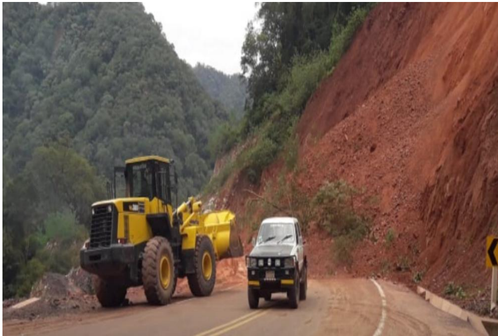
Figura Nro. 4 Derrumbes presentados en la carretera Entre Rios – Palos Blancos
