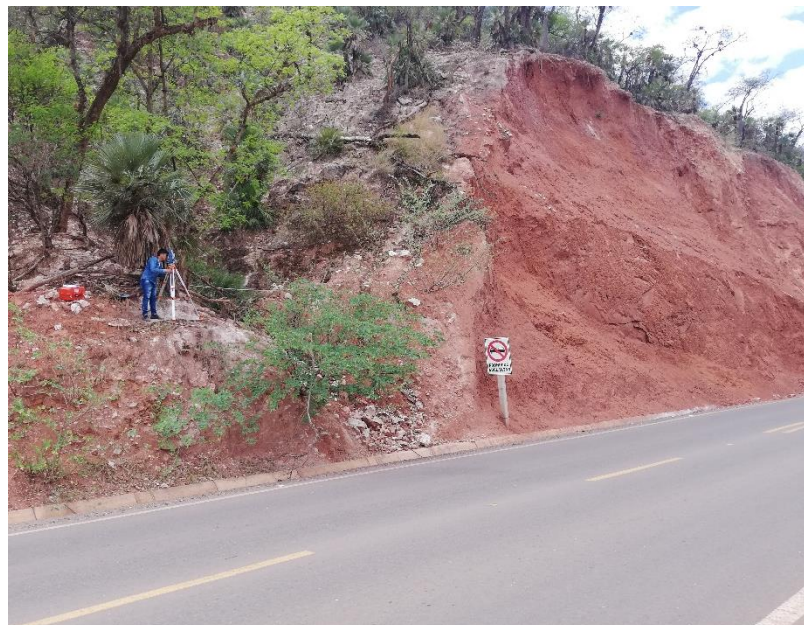
Figura Nro. 36 Levantamiento topográfico talud N °10
