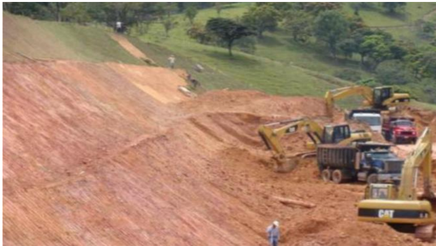
Figura Nro. 65 Disposición de maquinaria en la excavación de la vía interna en Valle Sur – Municipio de Itagüí
