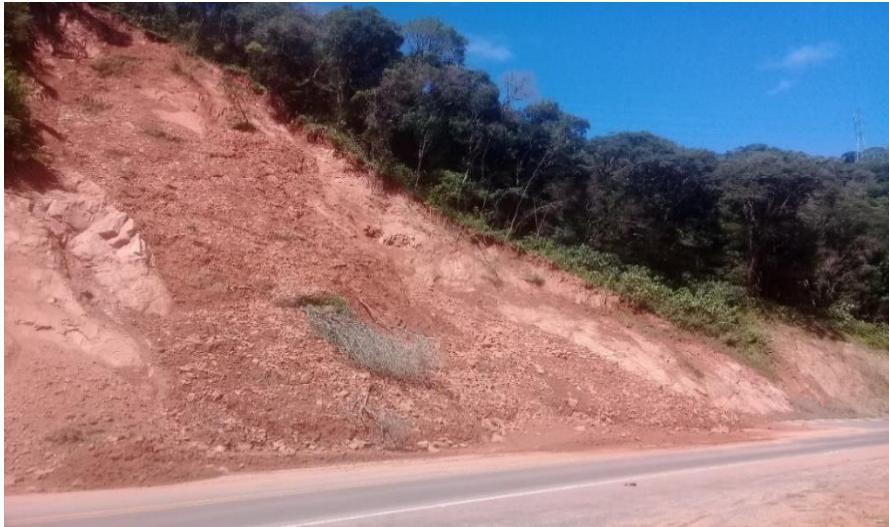
Figura Nro. 3 Deslizamiento del talud
