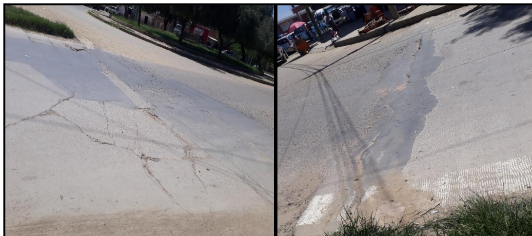
Figura 2.15. Mal estado de la superficie de rodadura sobre la Av. Circunvalación
