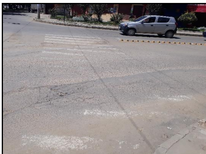
Figura 2.27. Cruce peatonal en mal estado. Av. Circunvalación
