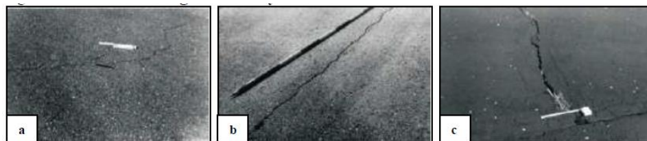
Gráfico 18 Fisuras longitudinales y transversales
