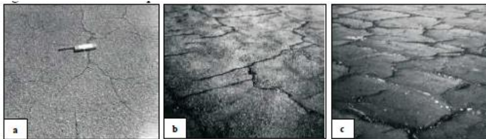
Gráfico 11 Fisuras en bloque
