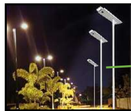
Luminarias con paneles solares
