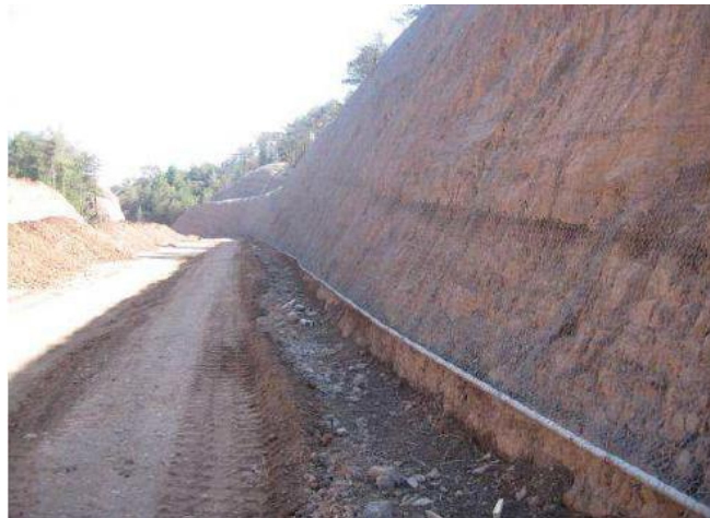
Figura 2.47 Sujeción con tubo metálico de acero
