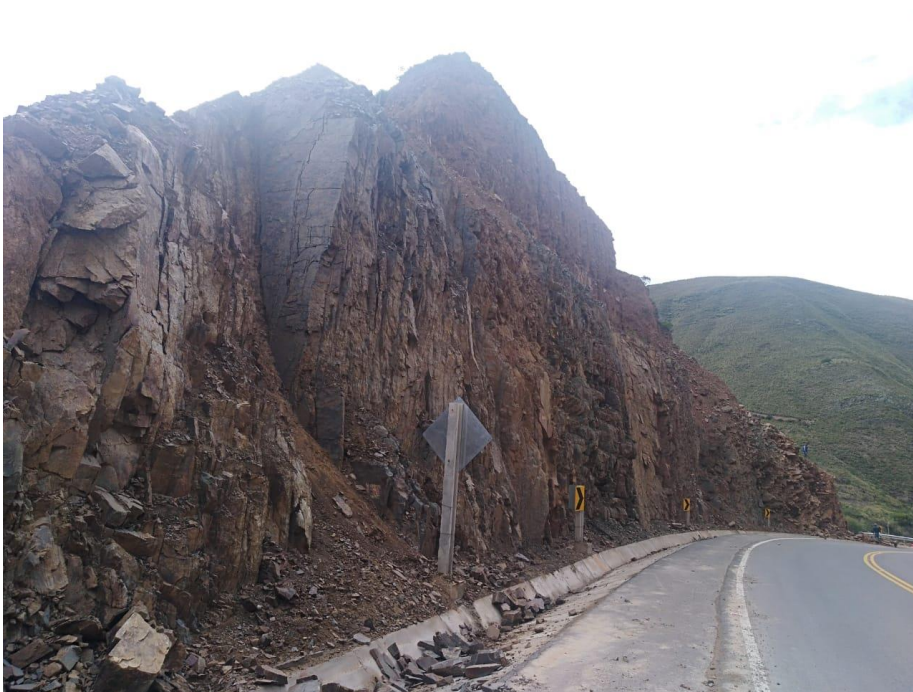
Figura 3.63 Talud fuertemente fisurado
