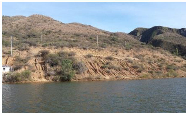
Figura 2. Erosión en el estribo derecho de la presa. (Autoría propia)
