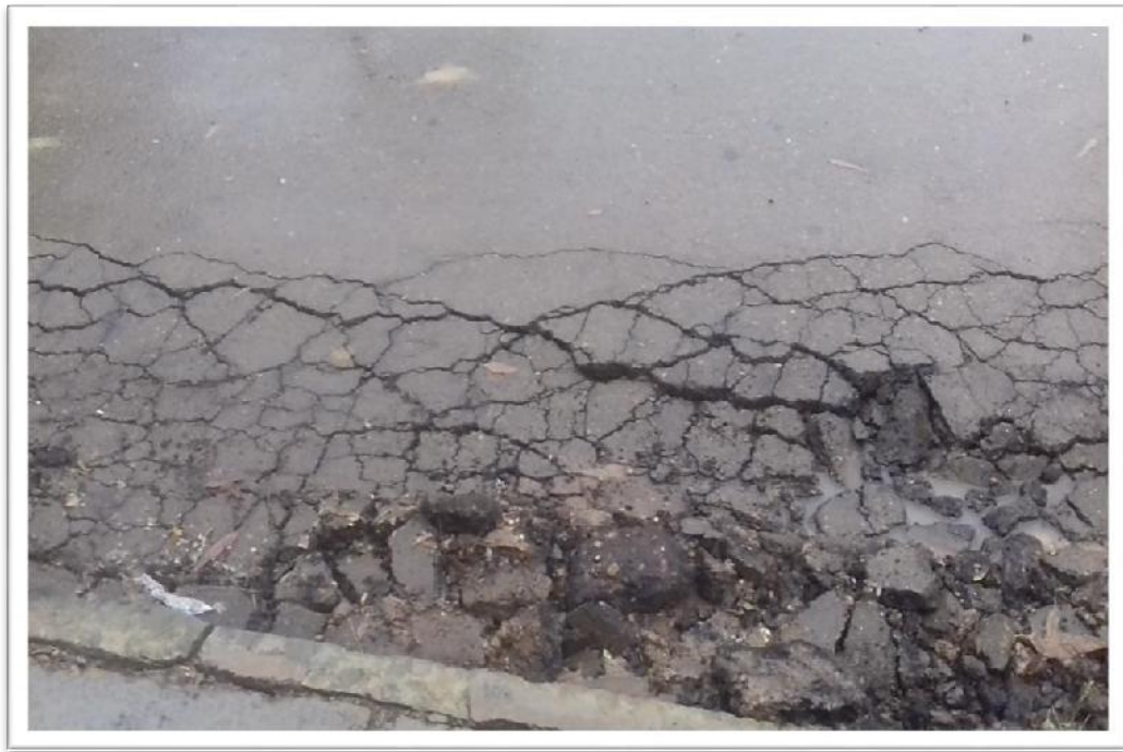
Figura 3.12. Avenida principal de campus universitario El Tejar. Carpeta asfáltica deteriorada.
