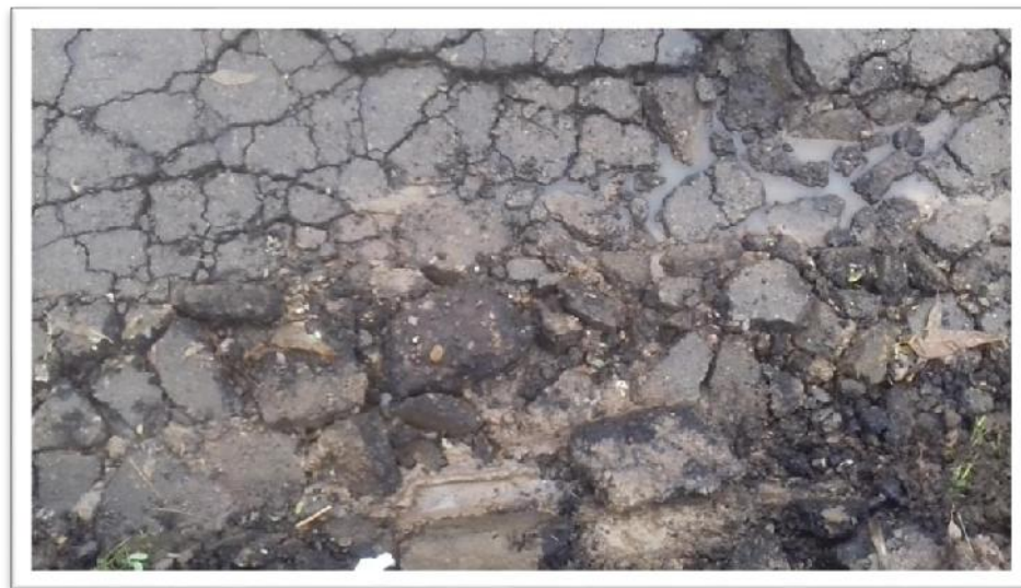
Figura 3.13. Carpeta asfáltica deteriorada. Campus El Tejar.
