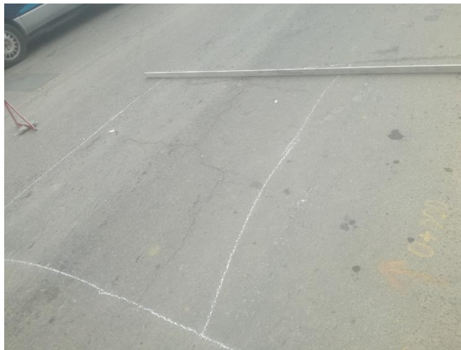
Figura 3. 9. Metodología de medición de fallas (m 2 ).
