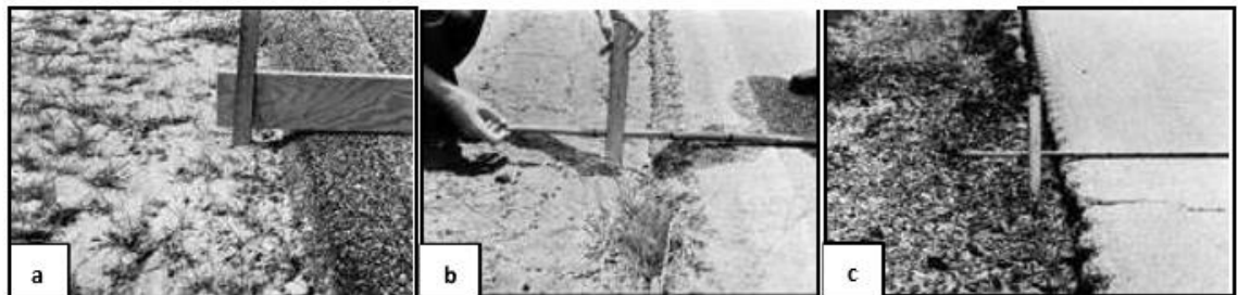
Figura 2. 20. Desnivel carril– berma.
