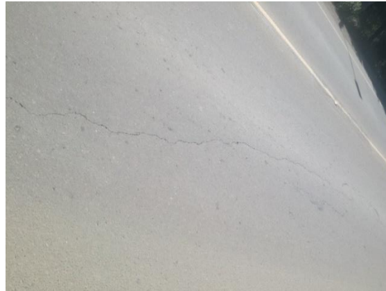
Figura 3. 15. Tipo de falla fisura transversal.
