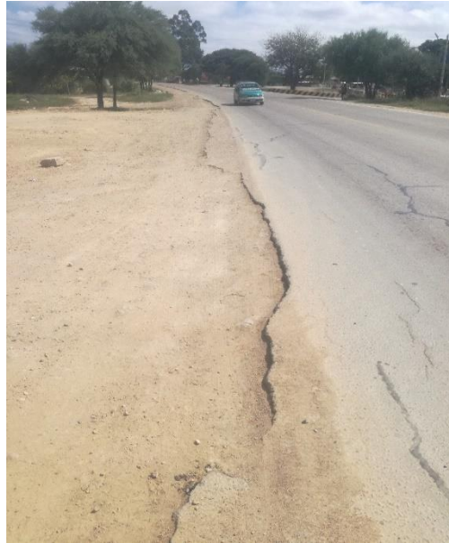
Figura 3. 13. Tipo de falla Fisura de borde.
