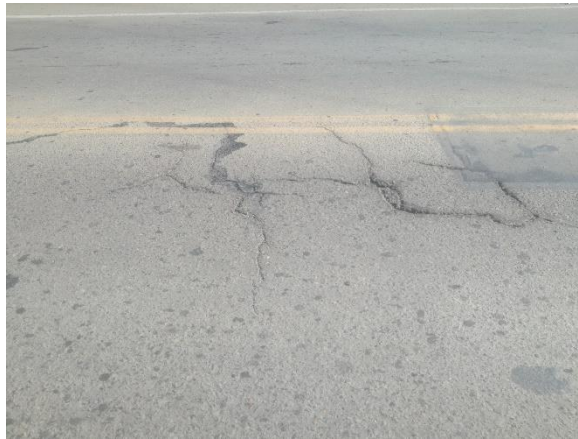
Figura 3. 12. Tipo de falla fisura en bloque.
