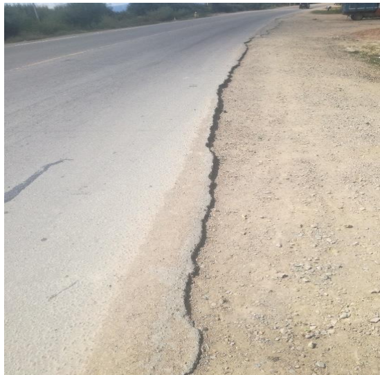
Figura 3. 14. Tipo de falla desnivel de carril.
