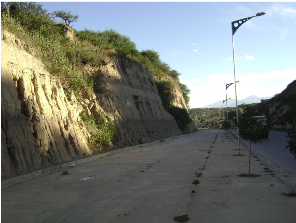
Desprendimientos de Talud
