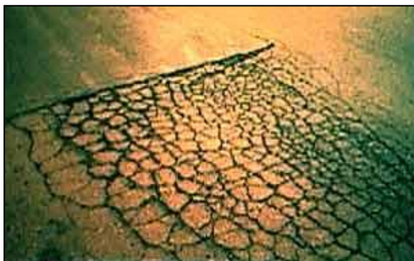
Figura 2.2. Formación de grietas en el pavimento
