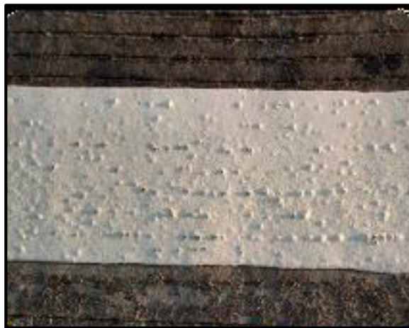
Figura 17. Burbujas en la superficie por humedad profunda en el concreto
