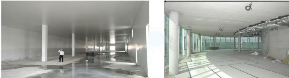
Figura 4. 2 Ausencia de vigas
