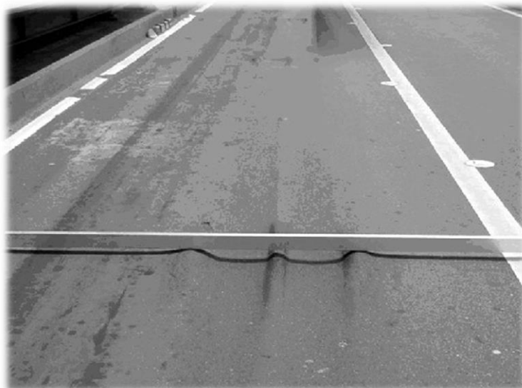
Figura 2.8: Efecto de la poca resistencia a la fatiga de la mezcla asfáltica.
