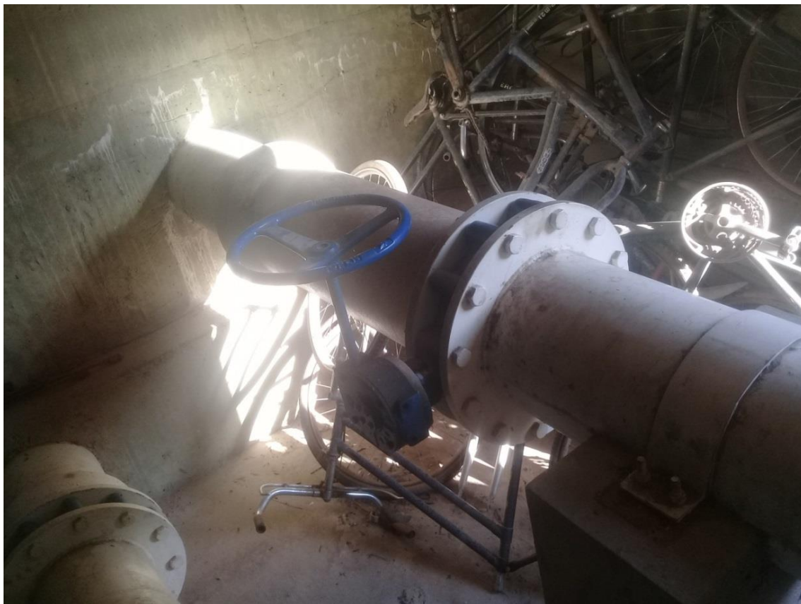
Figura 3.5 Válvulas de la red en el Tanque
