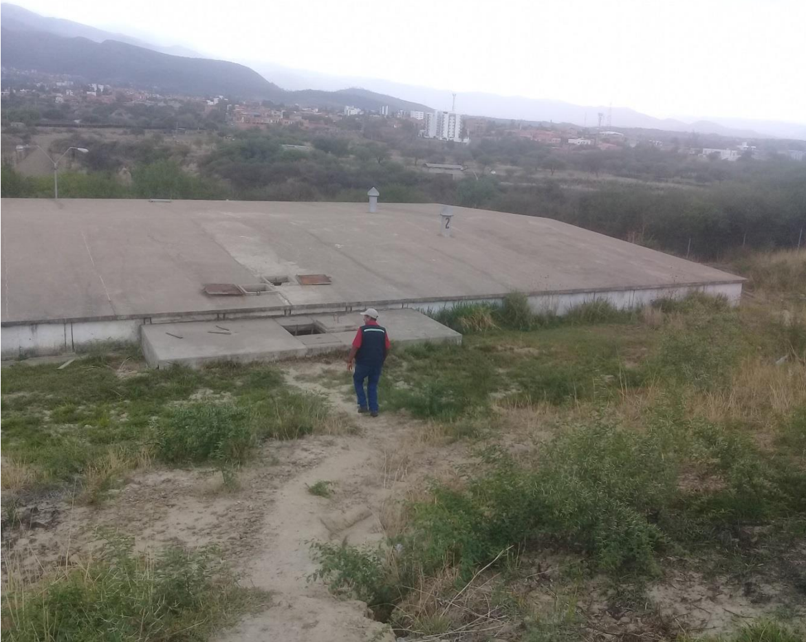
Figura 3.6 Tanque de Almacenamiento
