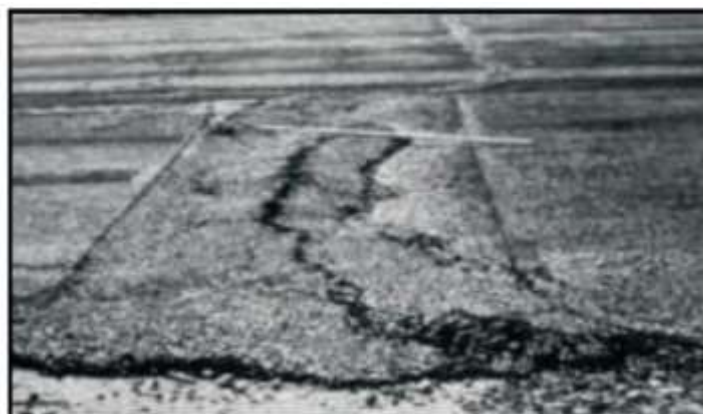
Imagen 2.9:17 Hinchamiento de alta severidad.
