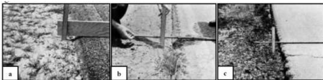
Imagen 2.9:9 Desnivel carril - berma de nivel de severidad bajo (a), medio (b) y alto (c).
