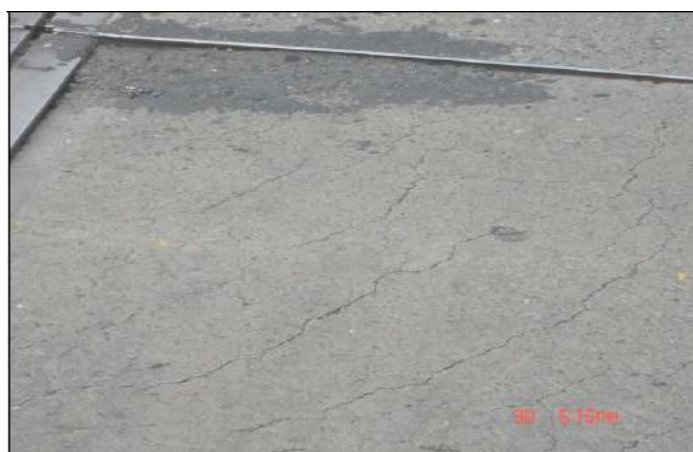
Fig. 3-13 FISURACIÓN POR APARICIÓN TEMPRANA
