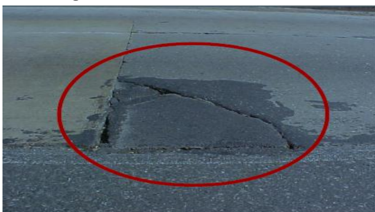
Fig. 3-17 FISURA DE ESQUINA
