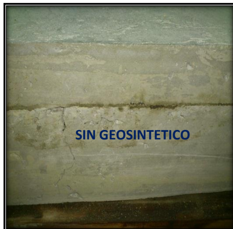
Fig. 4-63. Recapamiento de hormigón sin geosintético en vigas
