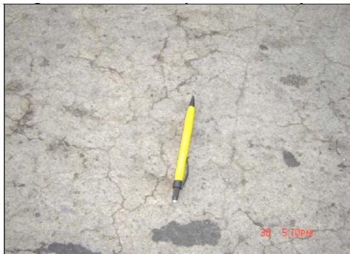
Fig. 3-12 FISURACIÓN POR RETRACCIÓN CON NIVEL DE SEVERIDAD BAJO
