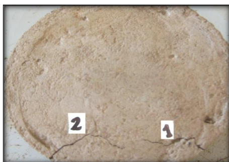
Fig. 4-71. Fisuras en la carpeta antigua
