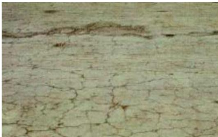
Fig. 3-19 FISURA EN BLOQUE
