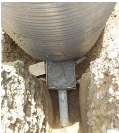
Figura 4. 12. Llegada de la tubería de 8" al tanque de ecualización
