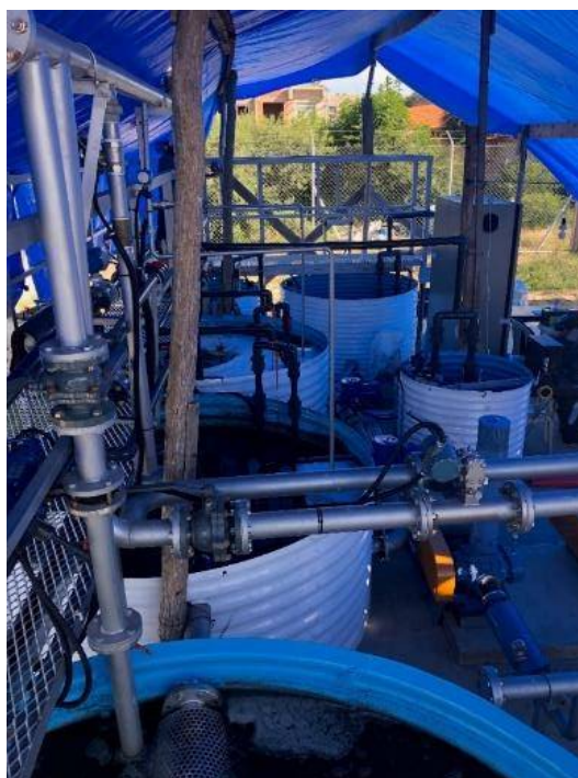
Figura 4. 27. Instalación general de los equipos electromecánicos
