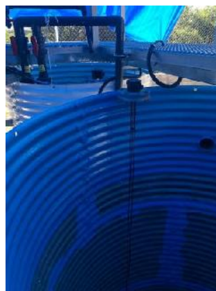
Figura 4. 41. Tanque de Almacenamiento de Lodos
