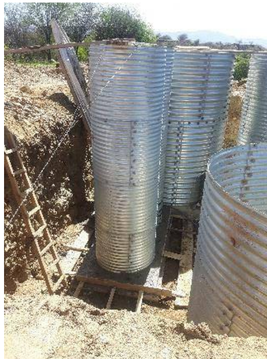
Figura 4. 7. Tanques sostenidos por alambres
