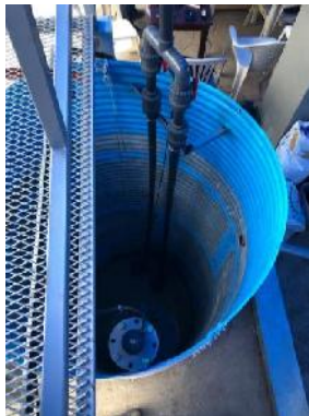
Figura 4. 40. Tanque de Almacenamiento de Efluente
