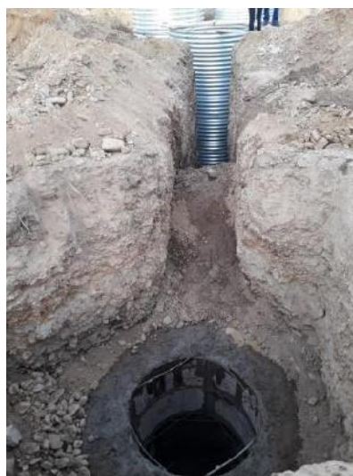
Figura 4. 11. Nueva cámara hacia la planta de demostración de tratamiento de aguas residuales
