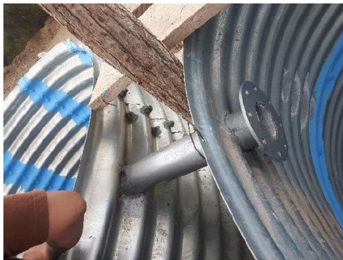
Figura 4. 22. Conexión de los tanques con tubería de fierro galvanizado y sus correspondientes accesorios
