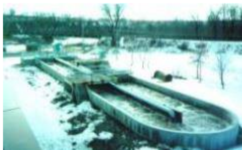
Okotoks WWTP 2.500 m 3 / d Modificación de zanja de oxidación, Ciudad de Okotoks, Alberta, Canadá (Stantec / Aqua MSBR)
