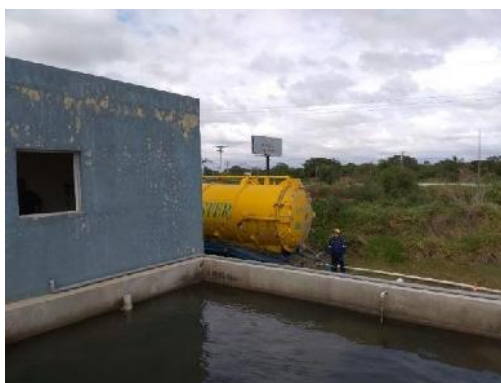
Figura 5. 13. Carro cisterna completamente llena en la planta de tratamiento en Santa Cruz
