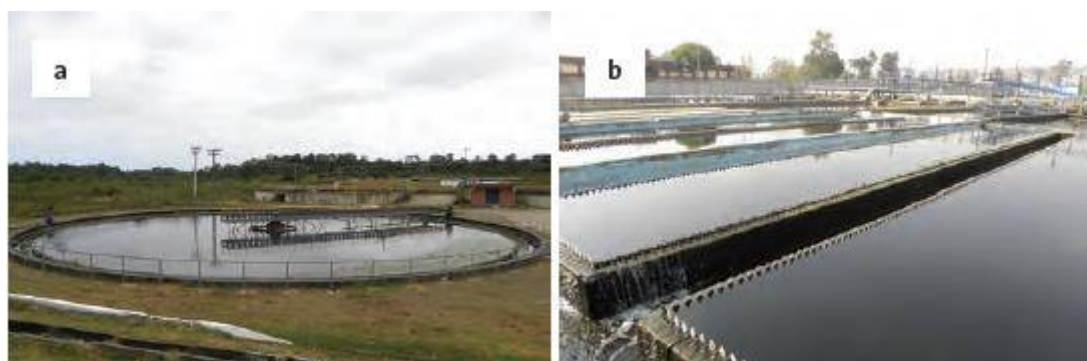
Figura 2. 6. Sedimentadores. a) Planta de tratamiento de aguas residuales municipales, Brasil b) Planta de tratamiento de aguas residuales municipales Cerro de la Estrella, México
