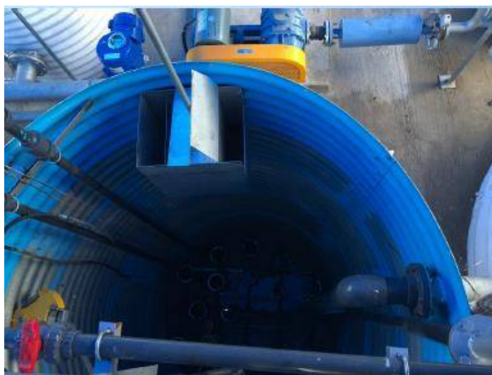
Figura 4. 38. Tanque SBR A/B
