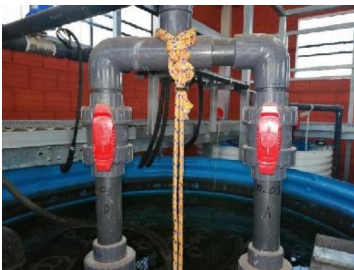
Figura 4. 51. Válvula de Tanque SBR
