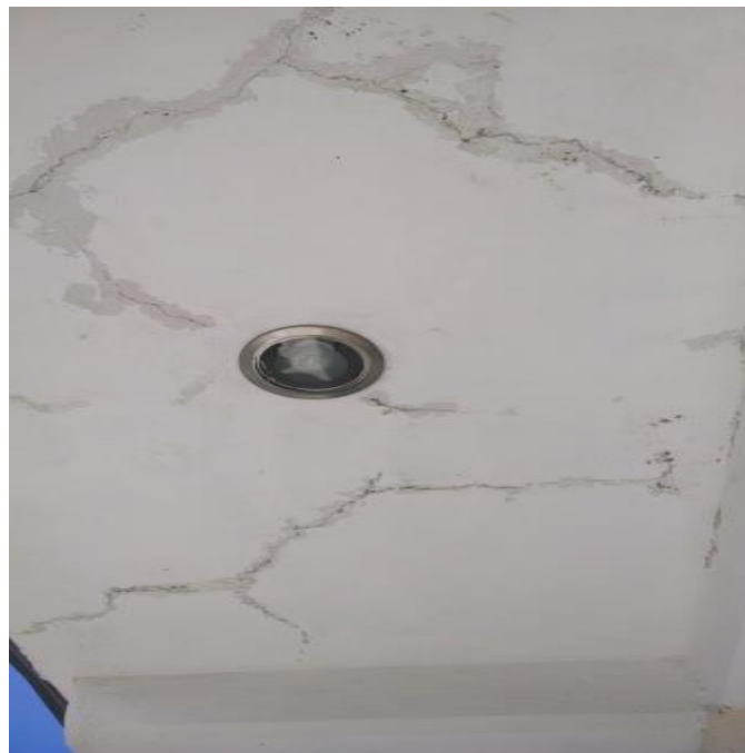
c) Cielo raso dañado por fisuras
