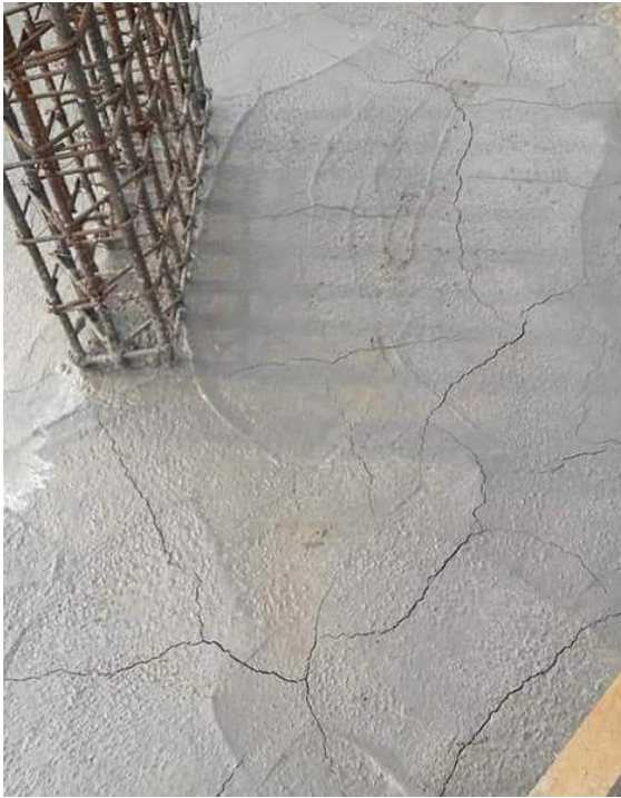
a) Fisuras en losa reticular
