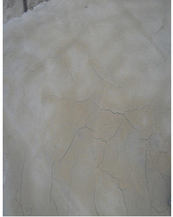
b) Fisuras en losa alivianada con viguetas pretensadas
