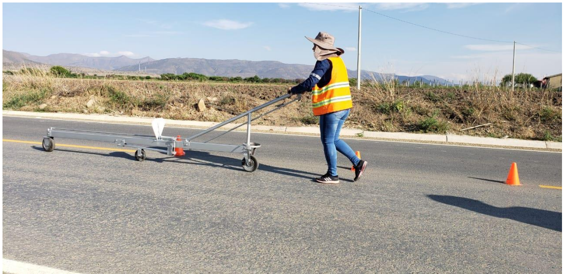
Figura. 3.4. Equipo HI-LO, puesto en marcha.
